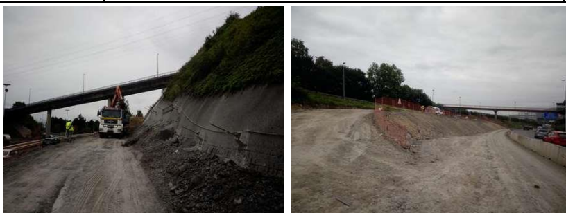
Zona de excavación en el talud D4b y plataforma construida en MU-3-1+330 con esas tierras
