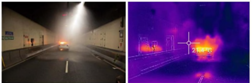
Figura 63: Activación del Deluge System la temperatura se reduce a 21,4°C
