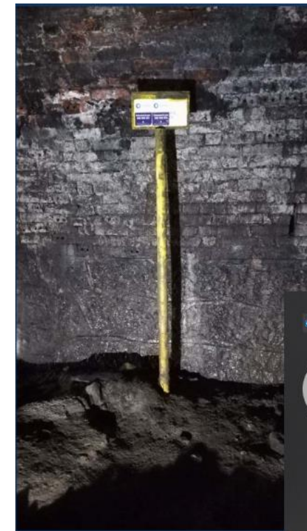
Imagen 14: Hito informativo del gasoducto
