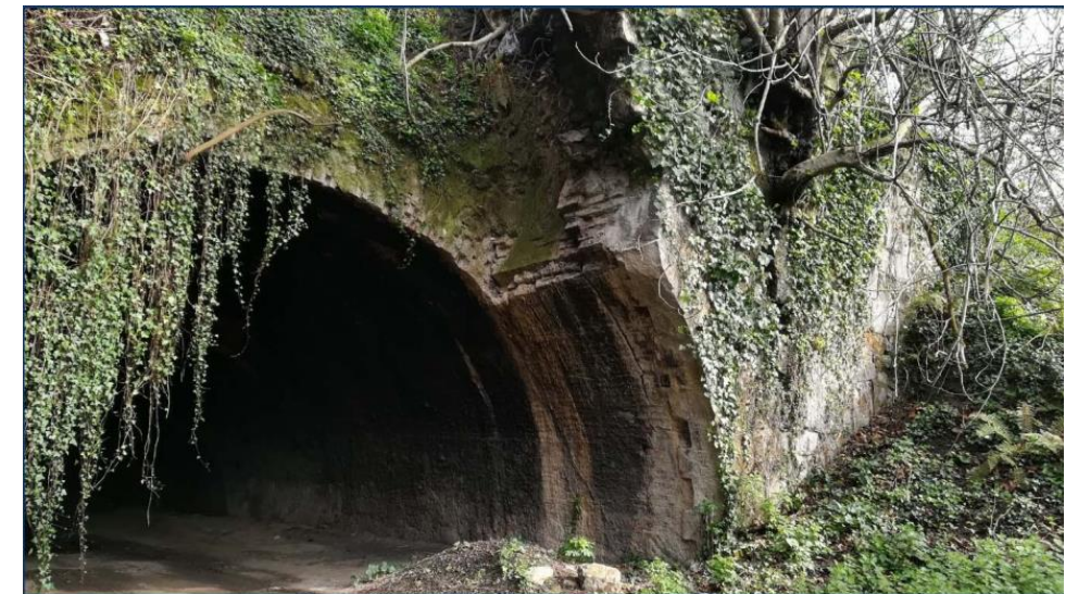
Imagen 15: Boquilla lado Basauri, donde se aprecian los desprendimientos propiciados por la presencia de varias higueras que crecen en su paramento
