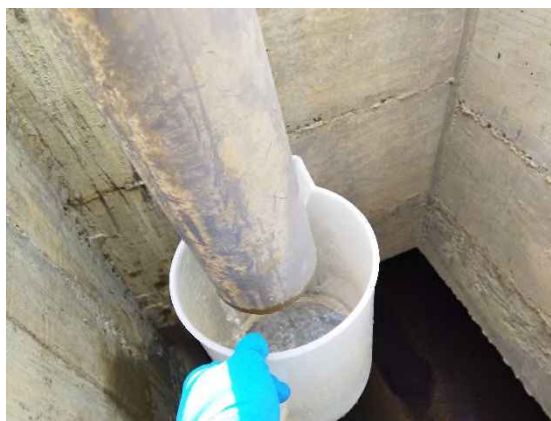
Foto nº13: Vertido de la depuradora
