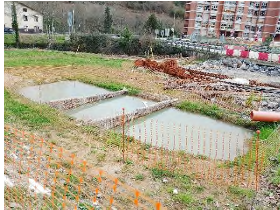
Foto nº21: Balsa de decantación Etxebarria
