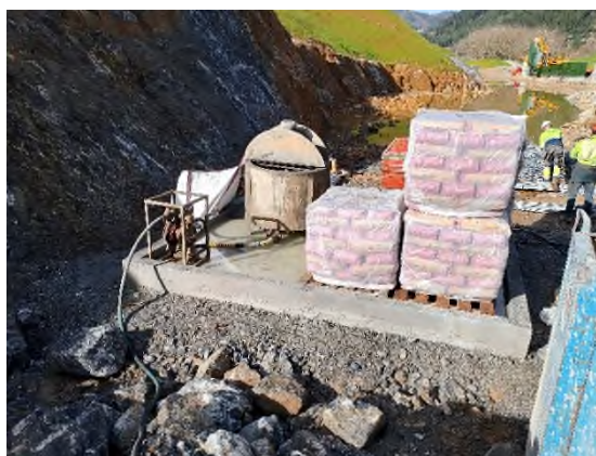
Foto nº27: Punto de acopio aislado hidráulicamente
