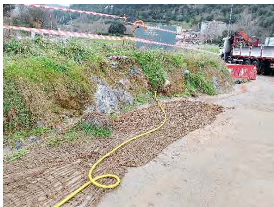
Foto nº19: Mantenimiento aguas abajo lavadero
