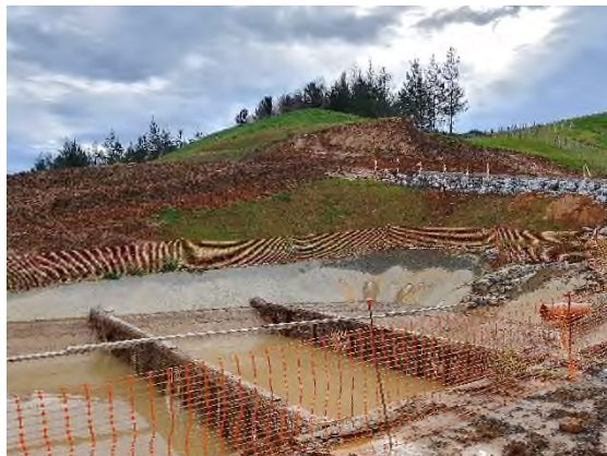
Foto nº21: Mantenimiento balsa del DS.
