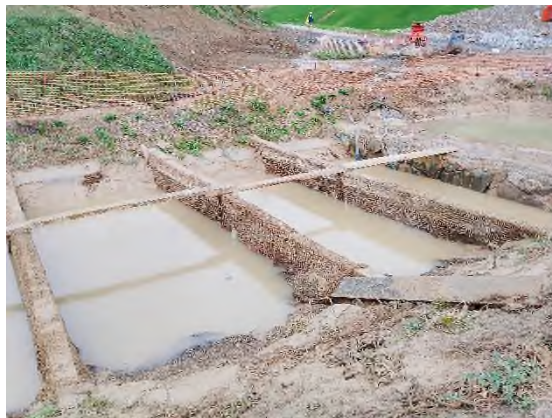
Foto nº22: Mantenimiento de la balsa de decantación eje-19
