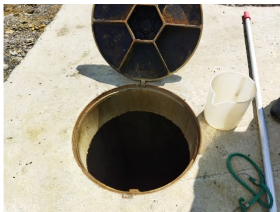
Foto nº19: Arqueta Dren de fondo
