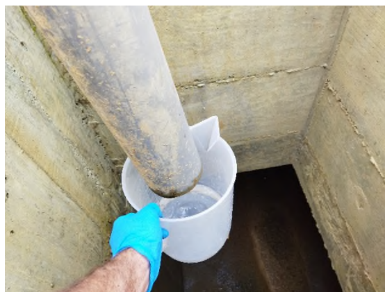
Foto nº18: Vertido de la depuradora
