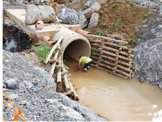
Foto nº11: Instalación pastillas floculantes en ODTC-02
