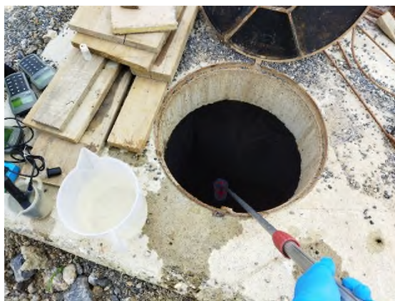
Foto nº21: Arqueta Dren de fondo
