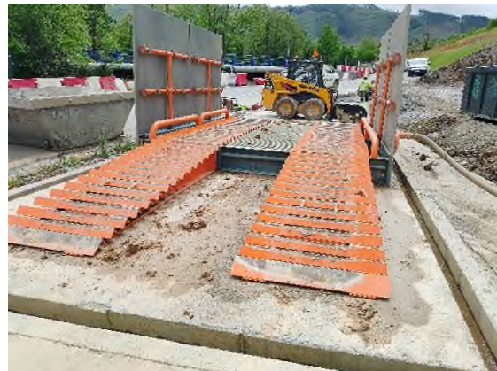
Foto nº5: Lavarruedas en Etxebarria
