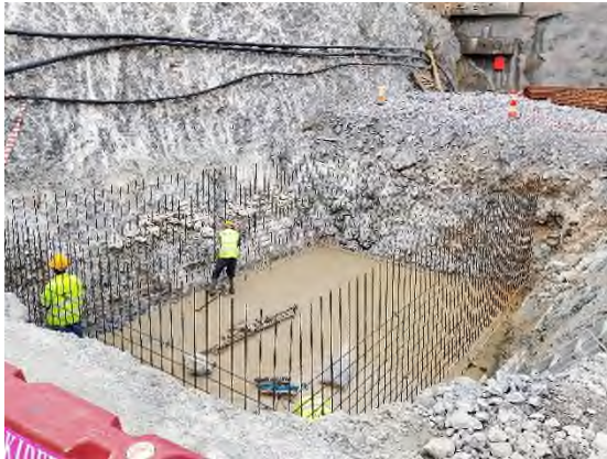
Foto n°7: Eje 21: instalaciones auxiliares S4
