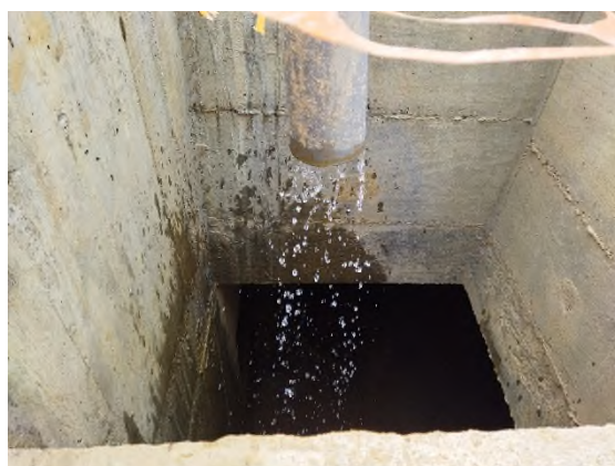
Foto nº15: Vertido de la depuradora
