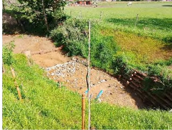
Foto n°20: Barreras habilitadas en ODT-04
