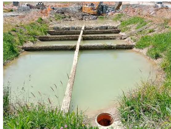
Foto n°2: Balsa de decantación Eje-19
