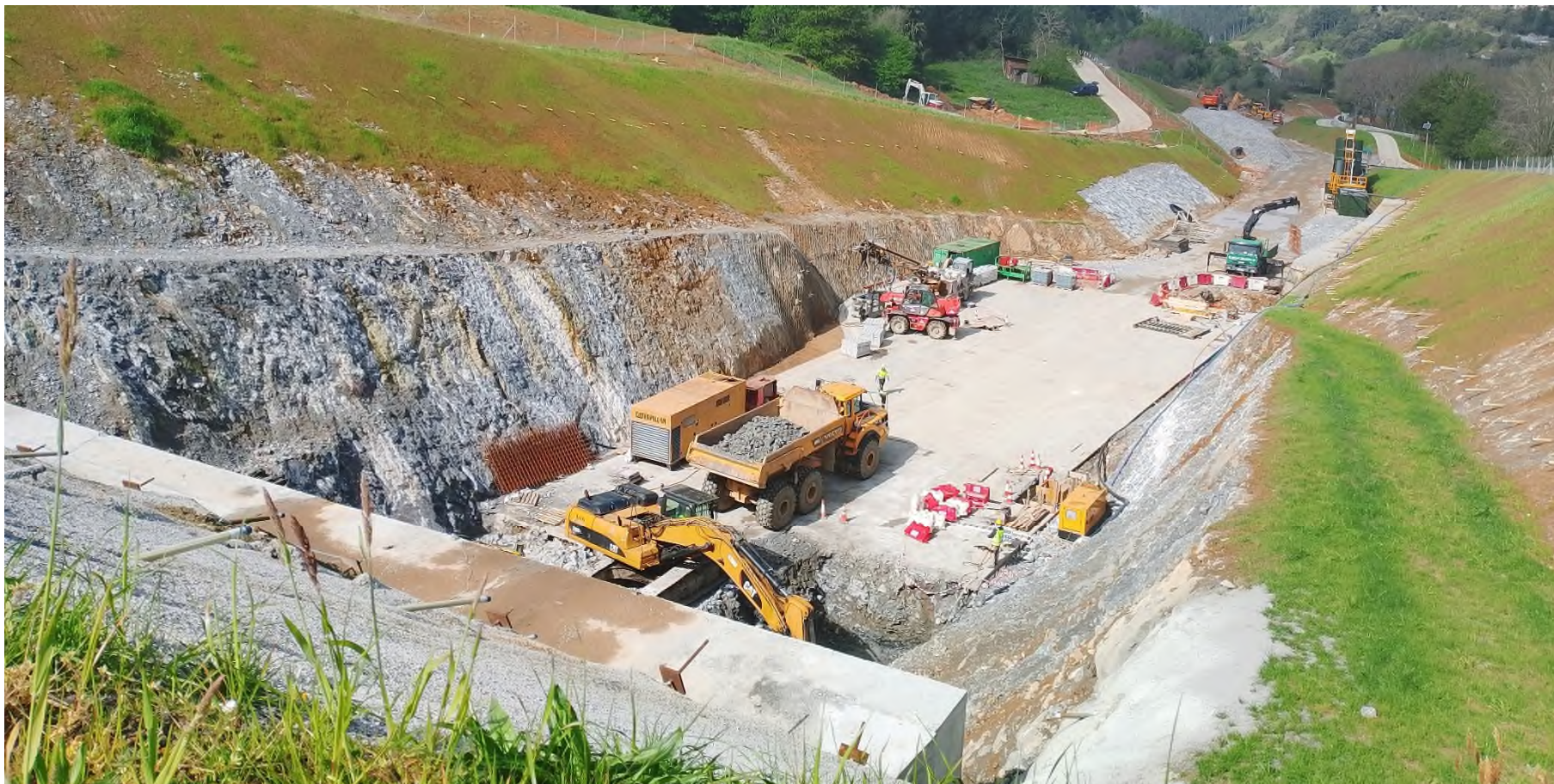
INSTALACIONES AUXILIARES EMBOQUILLE MARKINA
