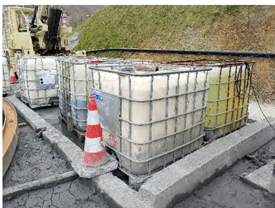
Foto nº13: Cubeto de retención habilitado en S5
