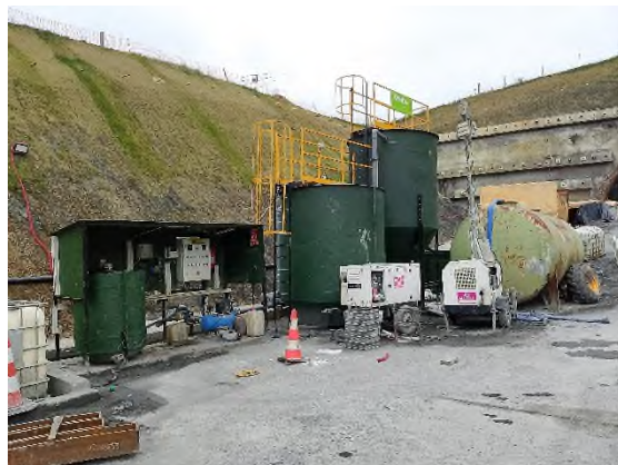
Foto nº5: Planta de tratamiento de Etxebarria.
