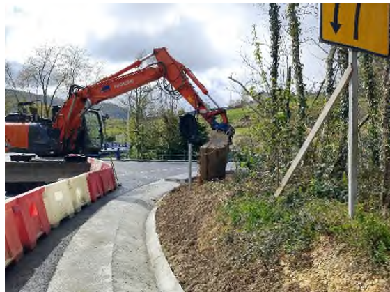
Foto nº6: Aporte de TV junto al estribo_2 en la parte interior de la rotonda.
