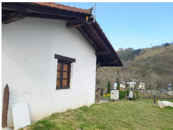
Foto nº34: Equipos instalados en Atain
