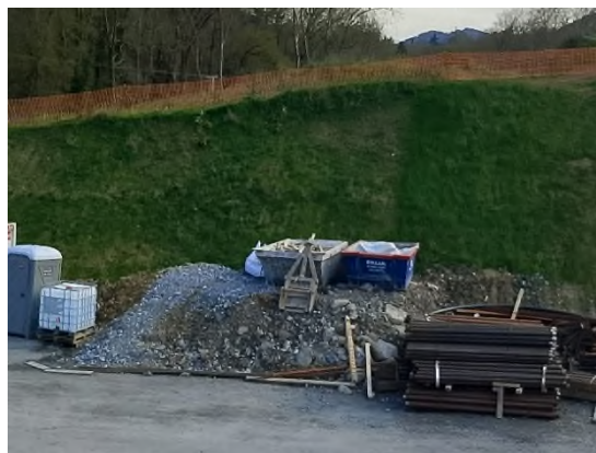
Foto nº20: Contenedores de RNPs en la S5.
