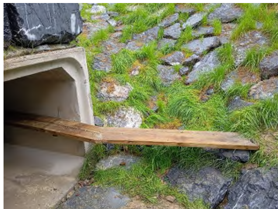
Foto nº40: Detalle del apoyo de la balda instalada.
