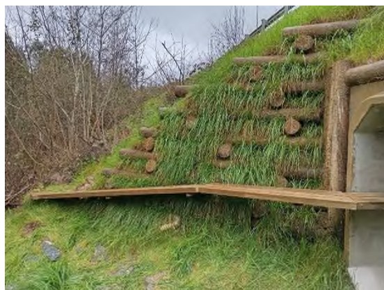
Foto nº42: Balda de madera aguas abajo de la ODT
