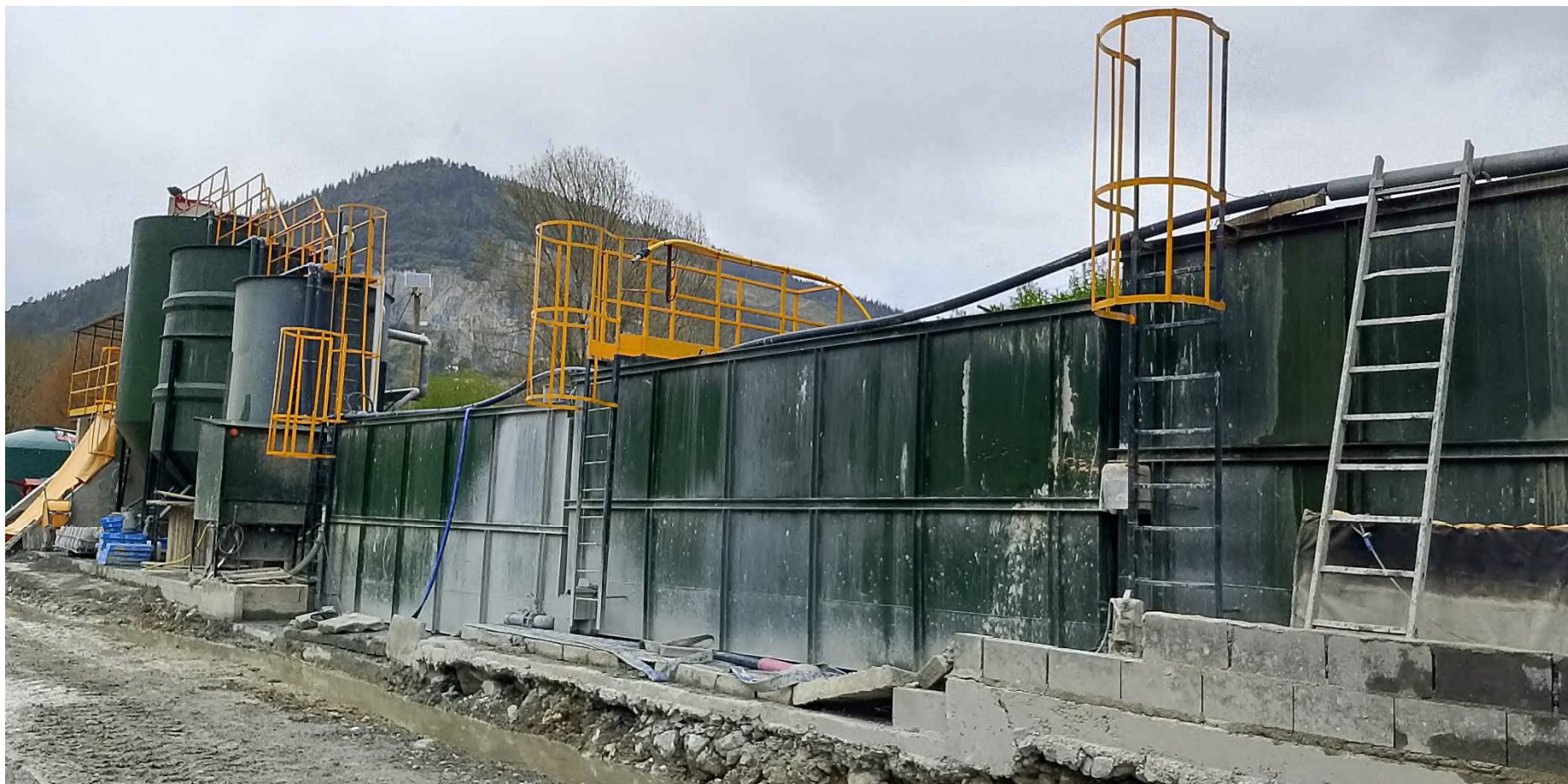
PLANTA DEPURADORA MARKINA
