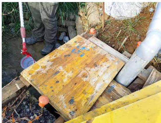
Foto nº29: Vertido de la depuradora
