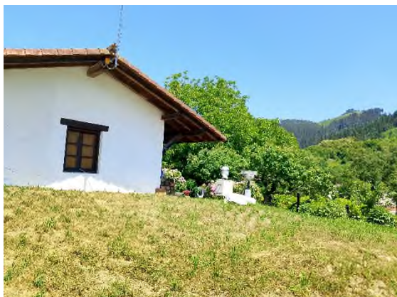
Foto nº18: Equipos instalados en Atain
