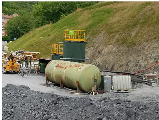
Foto nº30: Planta de tratamiento de Etxebarria.
