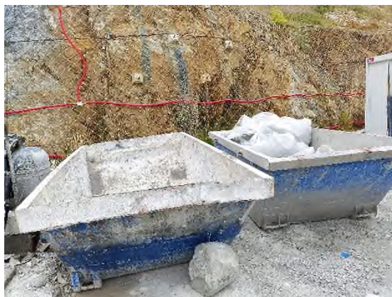
Foto nº42: Contenedores de RNPs en la S4.
