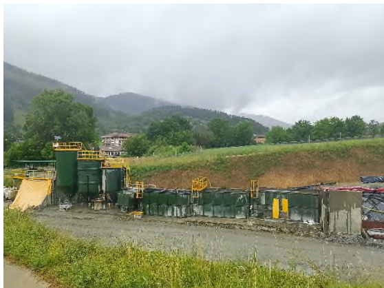
Foto nº29: Planta de tratamiento de Markina
