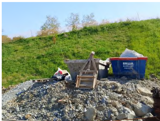
Foto nº50: Contenedores de RNPs habilitados en la zona auxiliar de Etxebarria junto a S5.
