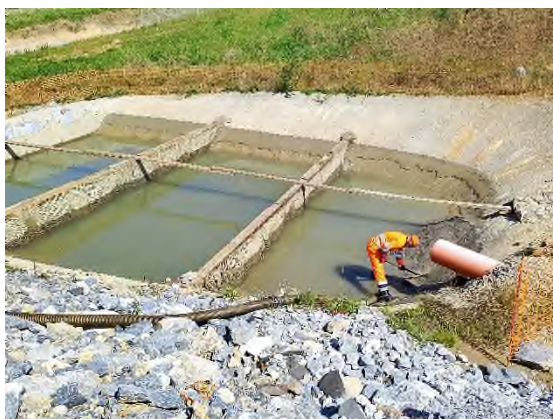
Foto nº35: Limpieza de la balsa de decantación del DS
