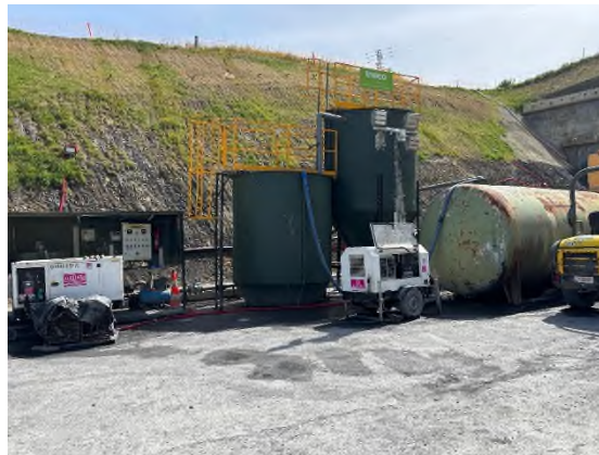
Foto nº36: Planta de tratamiento de Etxebarria.
