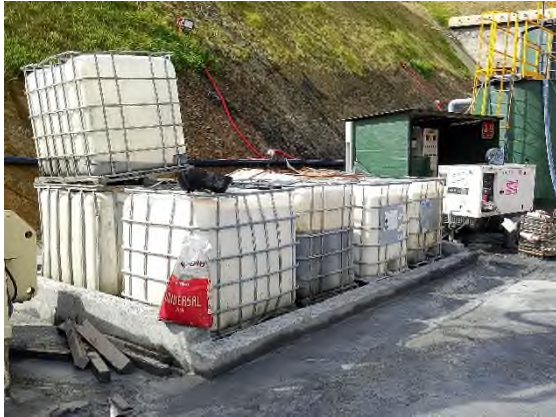
Foto nº43: Cubeto de retención habilitado en S5
