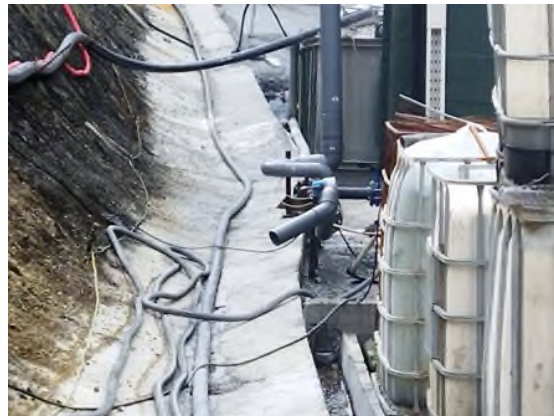
Foto nº19: Vertido depuradora de Markina
