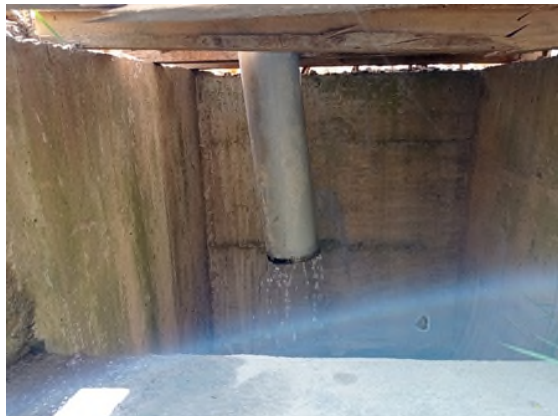
Foto nº18: Vertido depuradora de Markina
