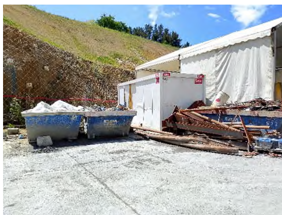
Foto nº52: Contenedores de RNPs en la S4.
