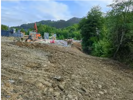
Foto nº17: Talud resultante en el arroyo Muniberreka
