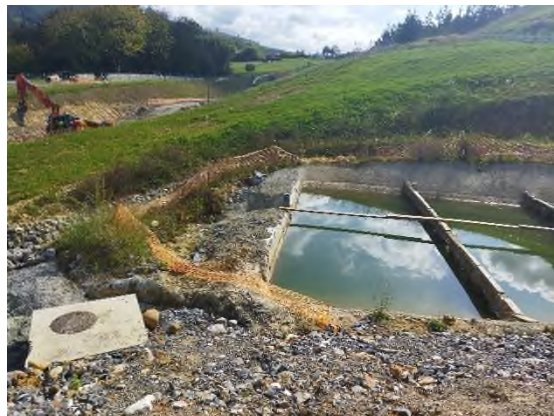
Foto nº5: Balsa de decantación del DS
