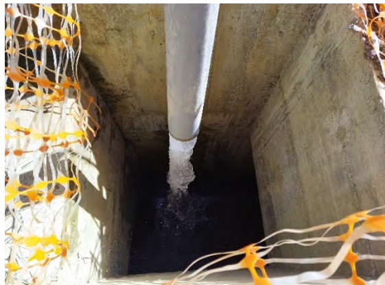
Foto nº18: Vertido de la depuradora
