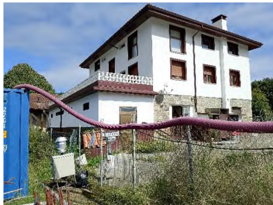
Foto nº21: Equipos junto a la rotonda Markina
