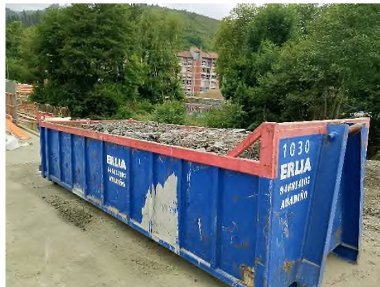
Foto nº15: Contenedor RNP en Etxebarria
