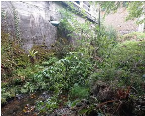
Restos vegetales sobre el cauce
