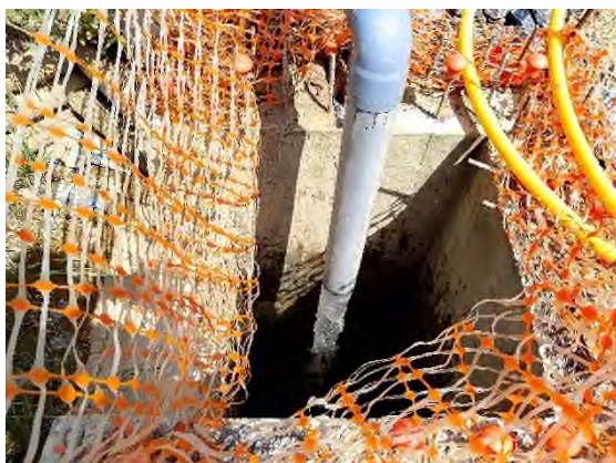
Foto nº19: Vertido de la depuradora
