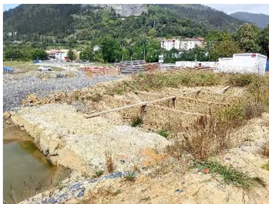
Foto nº2: Balsa de decantación eje-19
