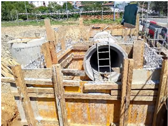
Foto nº7: Markina canalización eléctrica
