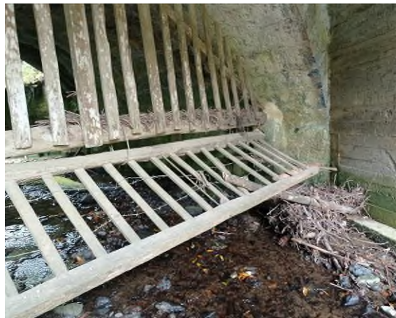
Ramas y maderas acumuladas en el lateral de la estructura
