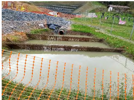
Foto nº19: Balsa de decantación Atain
