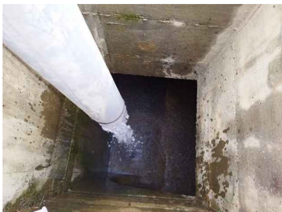
Foto nº14: Vertido de la depuradora
