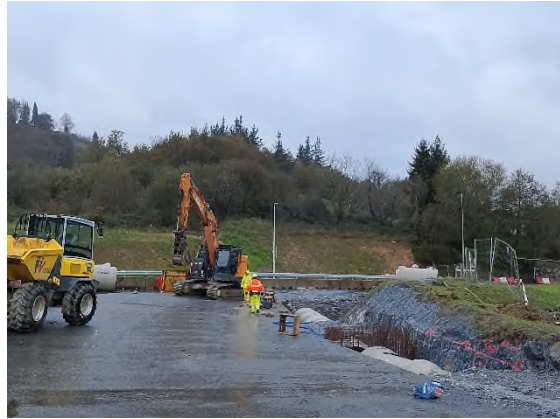
Foto nº8: ODT-01: colector D1200.
