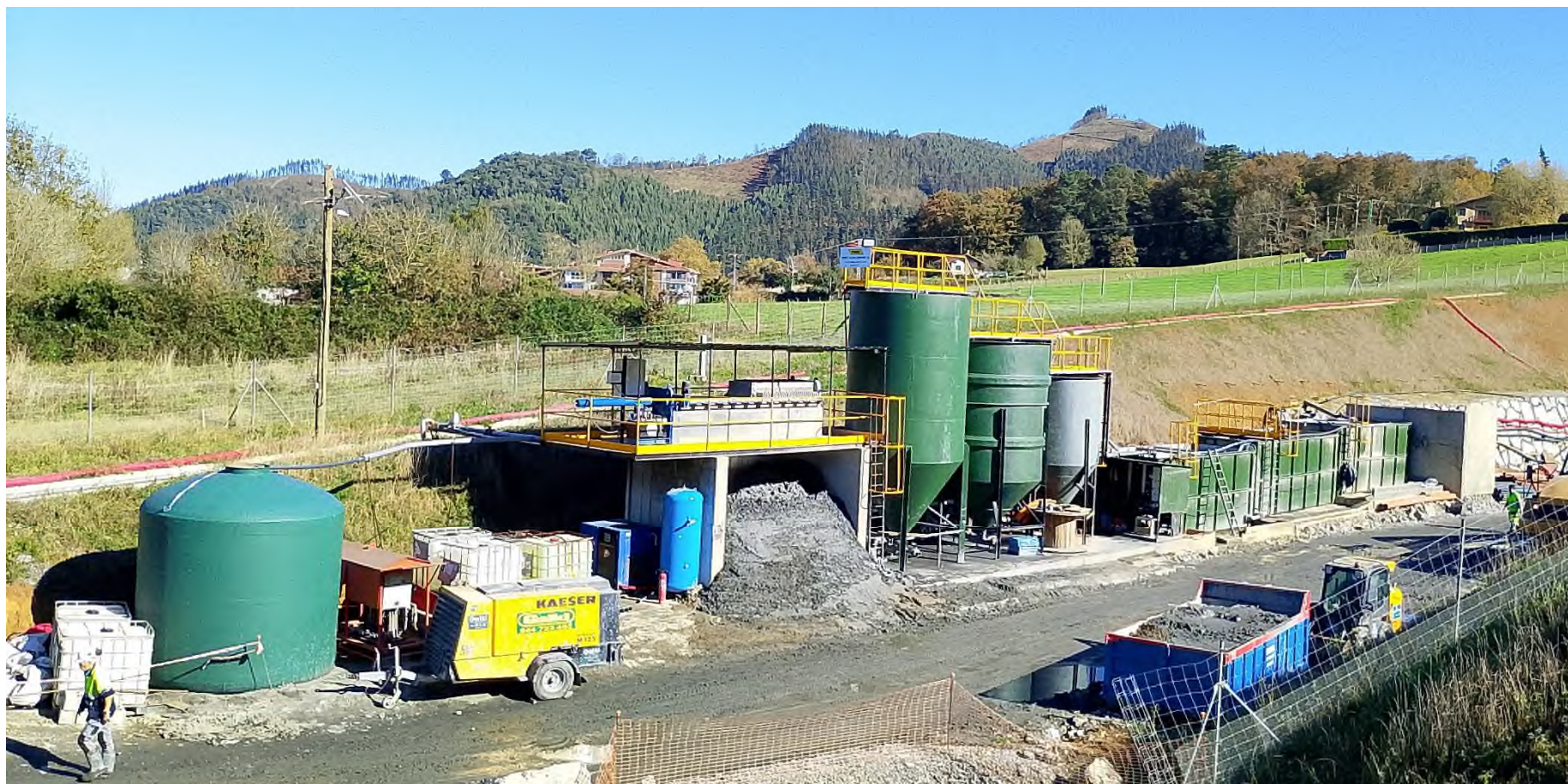
INSTALACION DEPURADORA MARKINA
