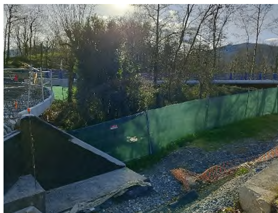
Foto nº21: Malla opaca en la zona de la E-2
