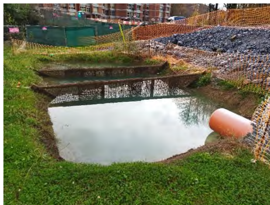
Foto nº16: Balsa de decantación Atain
