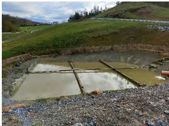
Foto nº25: Balsa de decantación del DS
