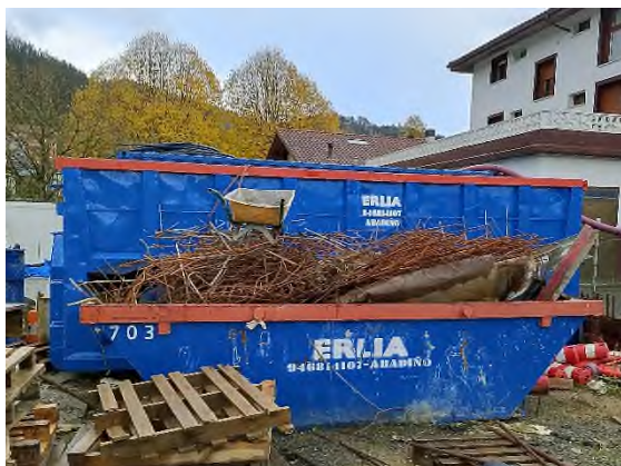
Foto nº16: Almacenamiento de RNP casetas Markina
