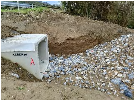
Foto nº42: Encachado de piedra en tierra aguas arriba.
