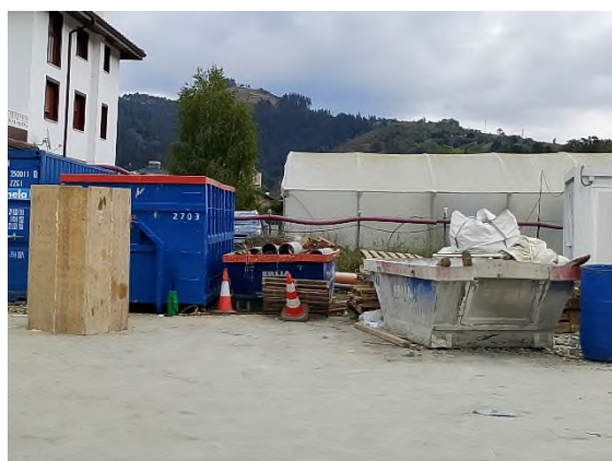
Foto nº9: Almacenamiento de RNP casetas Markina
