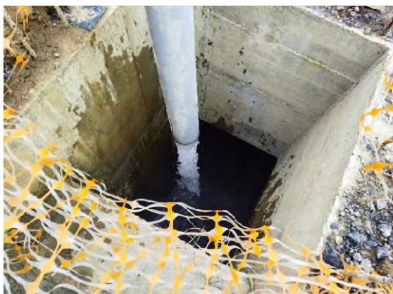
Foto nº16: Vertido de la depuradora
