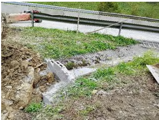
Foto nº26: Desvíos en las cunetas.
