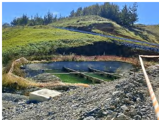
Foto nº2: Balsa de decantación del DS
