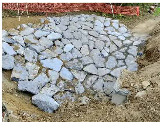
Foto nº33: Encachado de piedra en tierra aguas arriba.
