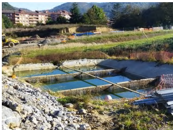
Foto nº19: Balsa de decantación del DS
