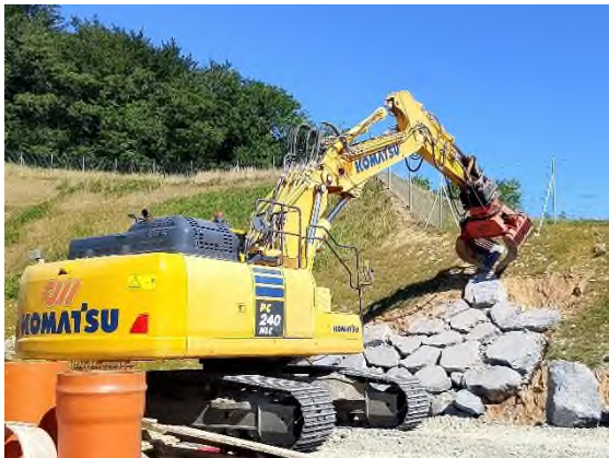
Foto nº5: Etxebarria Eje 21: piel de escollera
