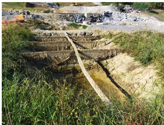
Foto nº2: Balsa de decantación eje-19
