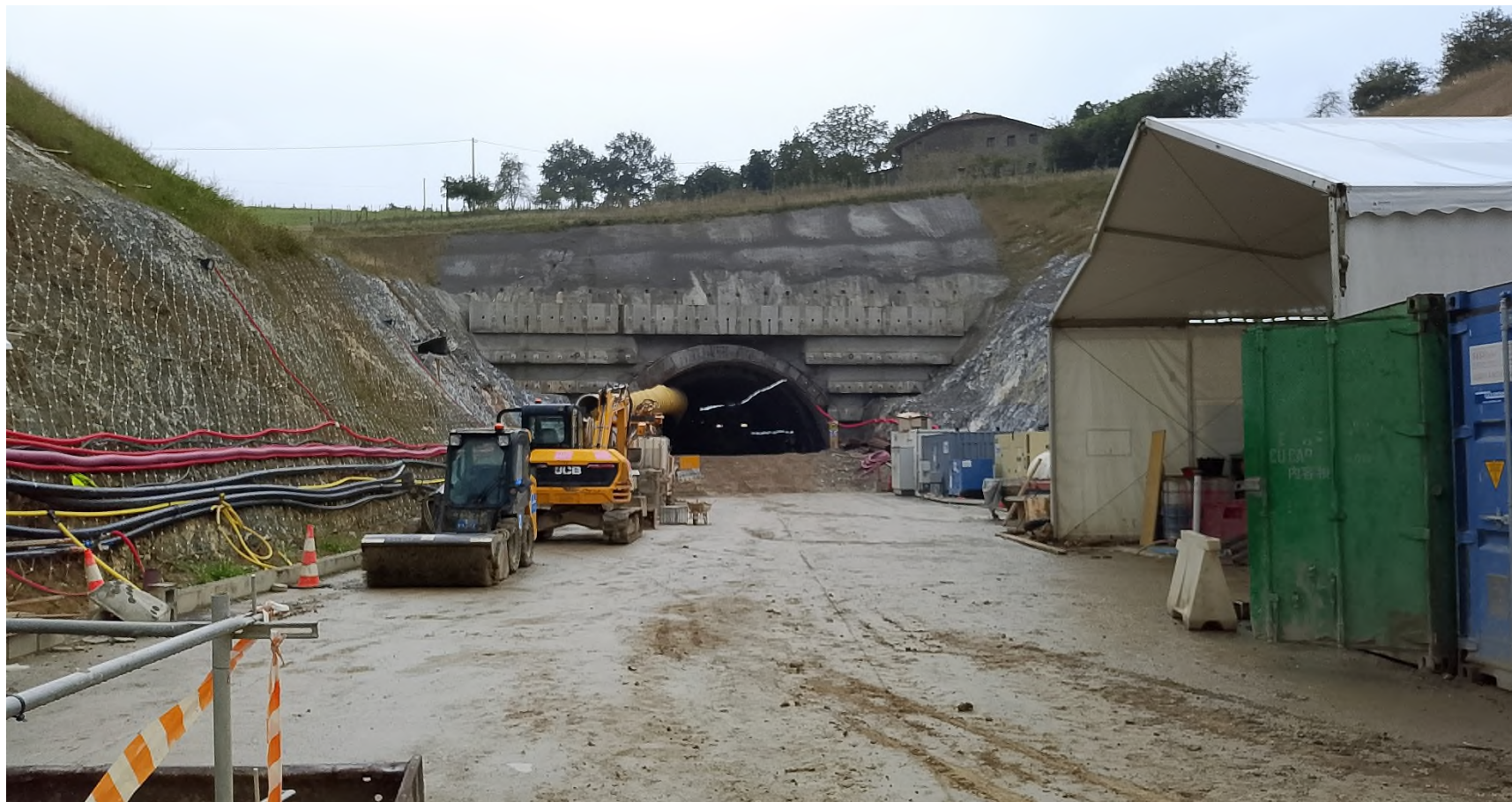
INSTALACIONES AUXILIARES – S4 MARKINA
