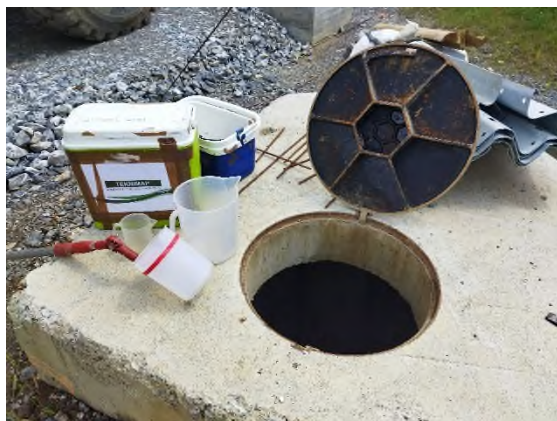
Foto nº22: Arqueta Dren de fondo
