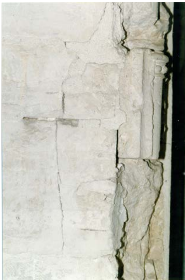
Figura 4. En el desarrollo decorativo que enmarca la hornacina, las pérdidas eran importantes.
