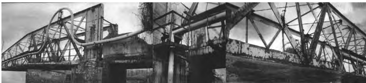
Figura 3. Algunos viejos puentes oxidados y olvidados, aquí y allá, con suerte, van sobreviviendo en el destierro de su obsolescencia.
