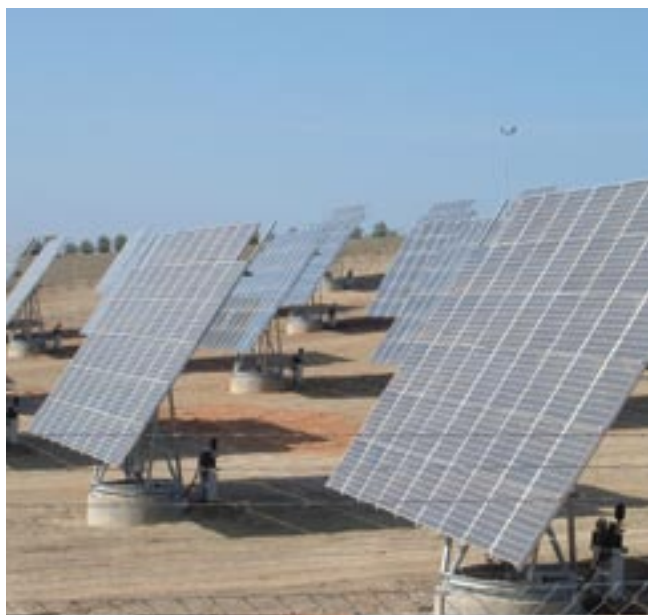
Albisa Solar enpresak Jaenen sustatutako instalazioa.
