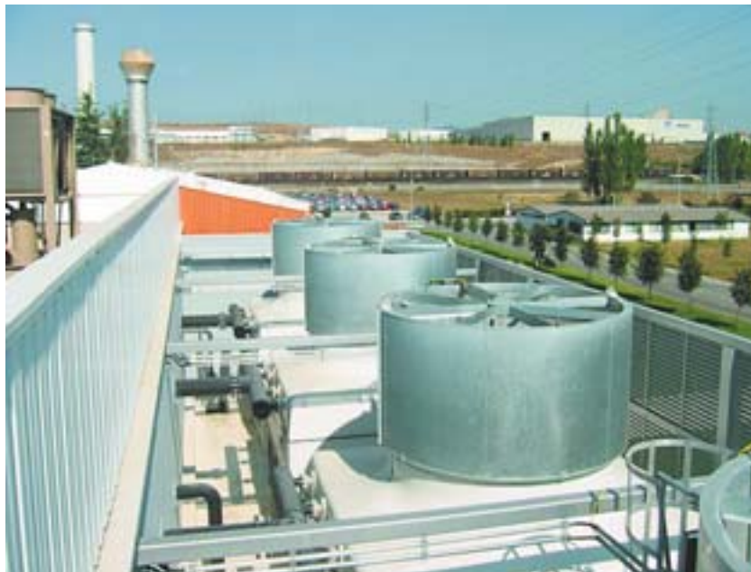
Las torres de refrigeración deben mantenerse en unas condiciones adecuadas de limpieza.
