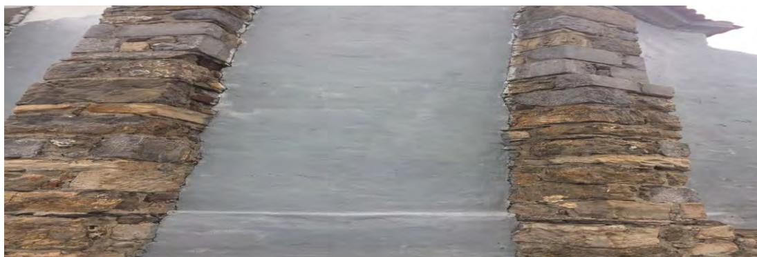
Fotografía 38: Una de las paredes de la ermita ha sido reconstruida, pero el resultado de la obra muestra resultados deficientes
