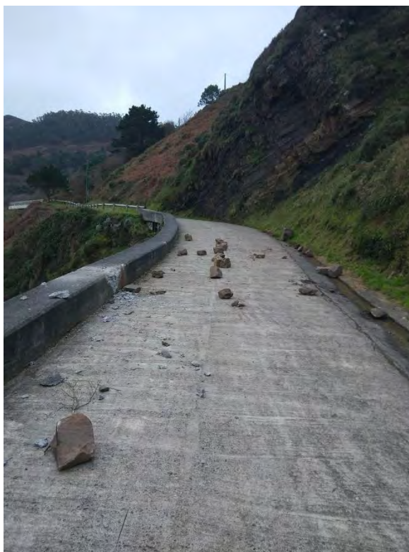
Desprendimiento en la ladera de Ermu
