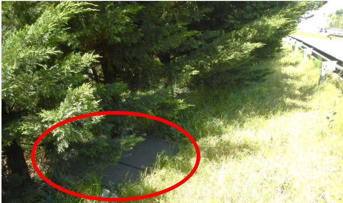
Arqueta de comunicaciones en terraplén A-8 junto a ramal aceleración Ugaldebieta.
