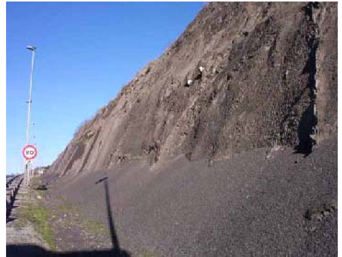
Acumulación de lajas al pie del talud en uno de los taludes de la A-8
