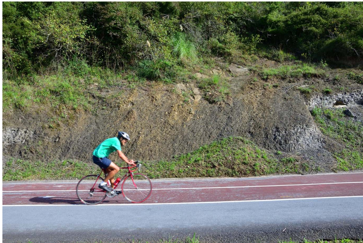
"Slump" próximo al barrio de Urioste.
