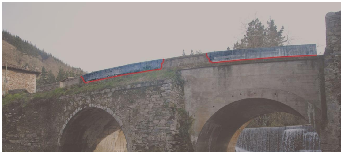
Figura 35. Rotura y arreglos de los pretiles en época contemporánea, registrando las UUEE 18 y 19 a la izquierda de la fotografía y las número 16 y 17 a la derecha de la misma.
