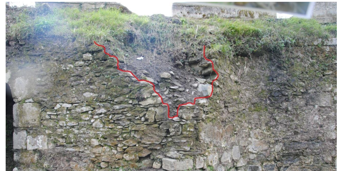
Figura 34. Ruina documentada en la zona del primitivo estribo del puente y de la reforma del aliviadero, aguas abajo.
