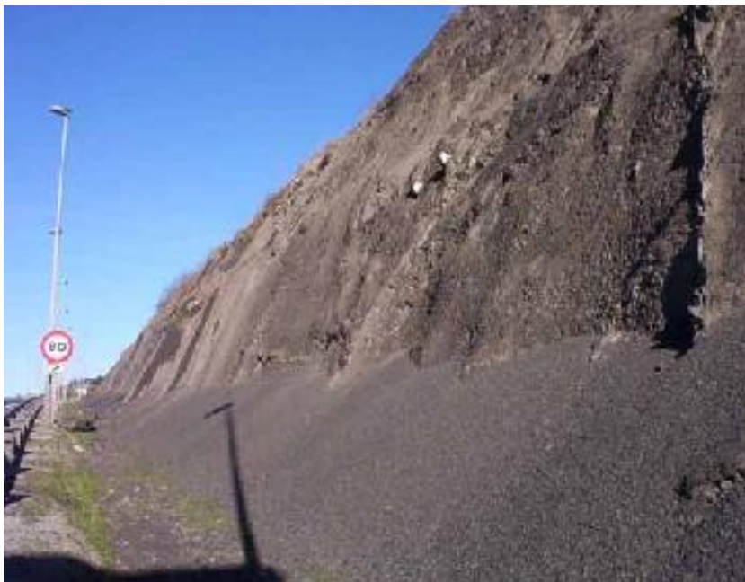
Acumulación de lajas al pie del talud en uno de los taludes de la A-8
