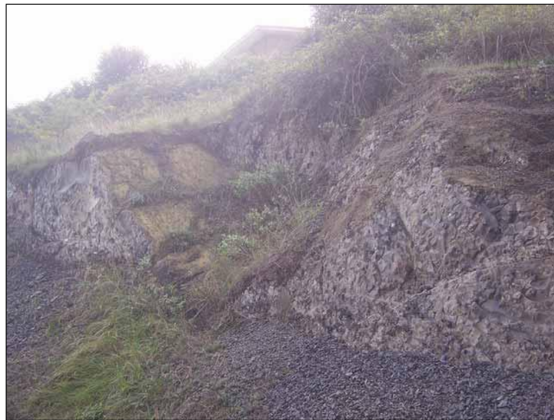
Rotura en cuña y acumulación de lajas en talud del bidegorri
