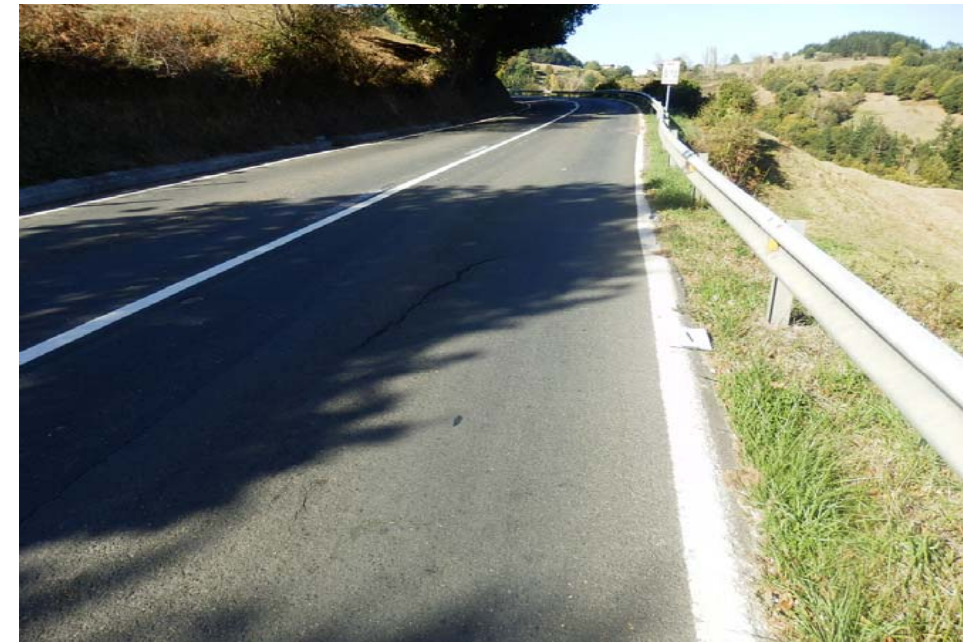
Grietas a 1.5m de la línea blanca
