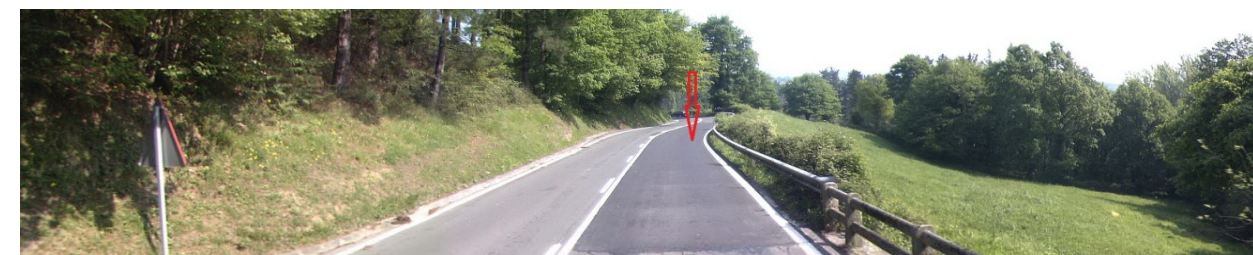
Vista de un parche de aglomerado sobre la carretera
