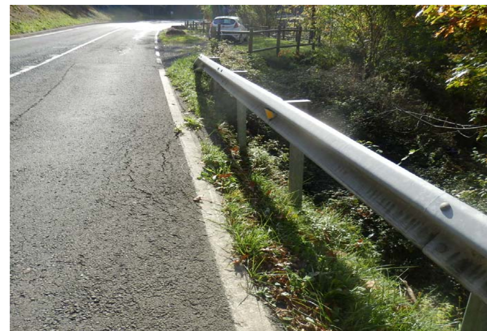
Detalle de las grietas en el carril izquierdo
