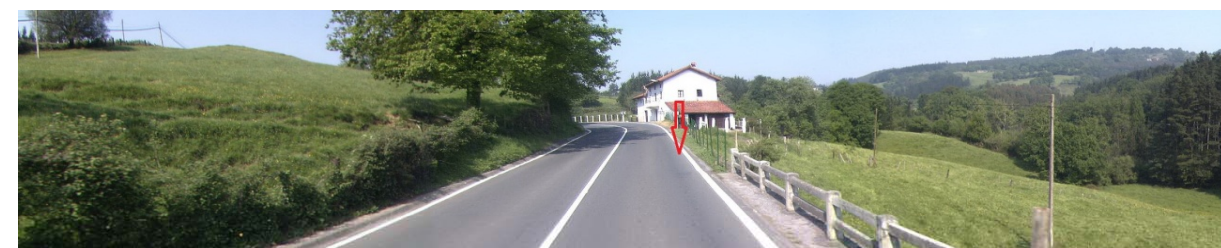
Vista de las grietas sobre la carretera
