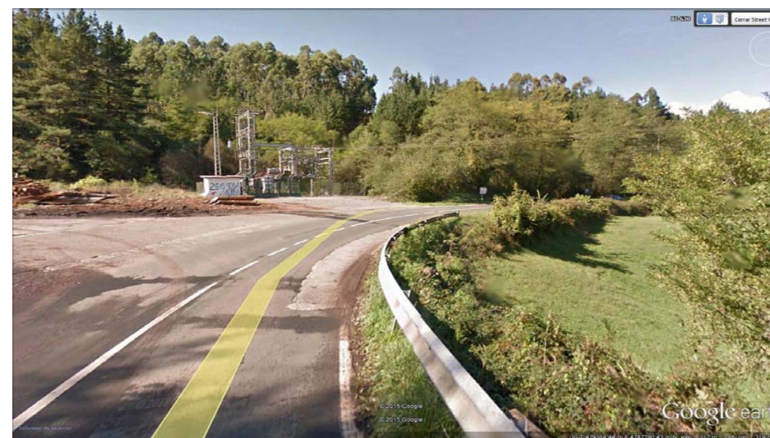
Detalle de un parche de aglomerado en el carril derecho
