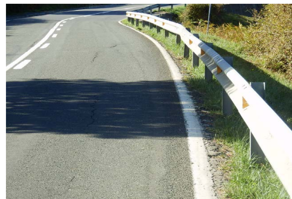
Detalle de las Grietas
