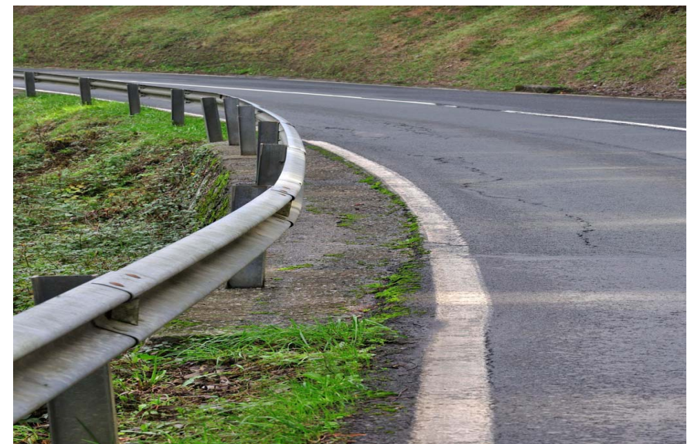
Vista de las grietas sobre el carril derecho de la carretera
