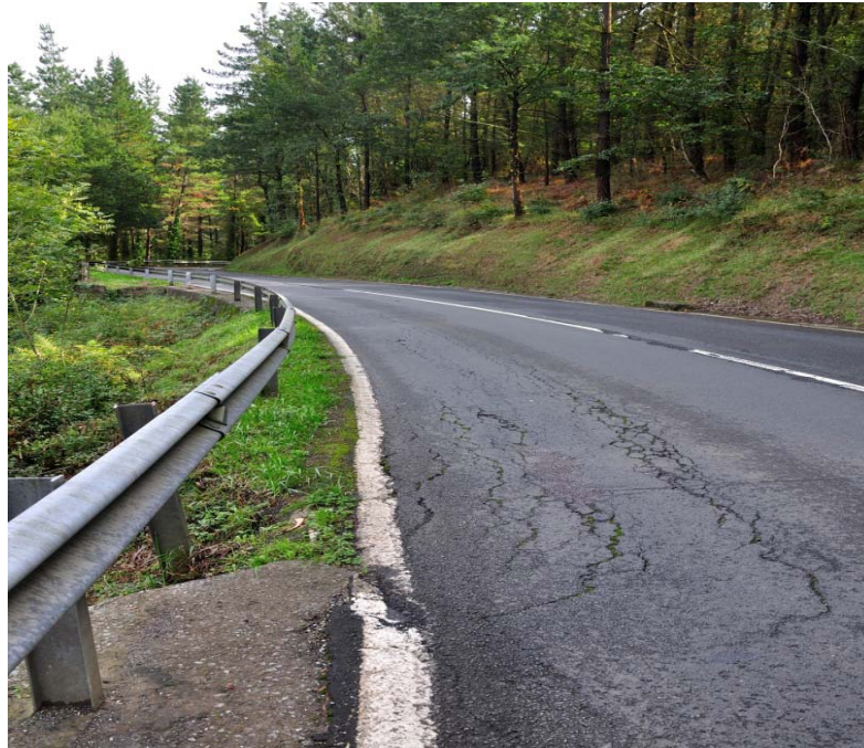
Vista de las grietas sobre la carretera, antes de un muro existente
