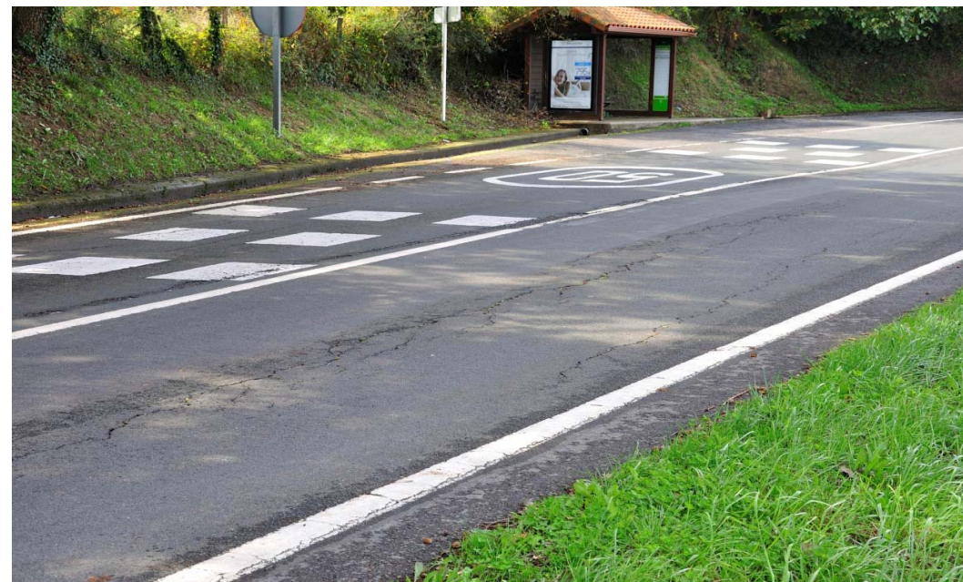
Vista de las grietas sobre la carretera
