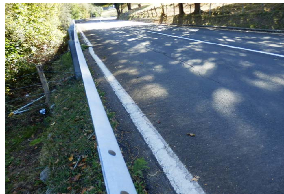
Detalle de las grietas a 1.5m de la línea blanco.
