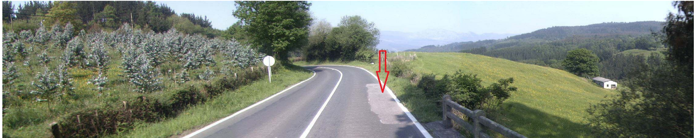
Detalle de un parche en la capa de aglomerado
