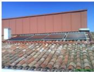
3.43: Instalación solar térmica en las instalaciones municipales
