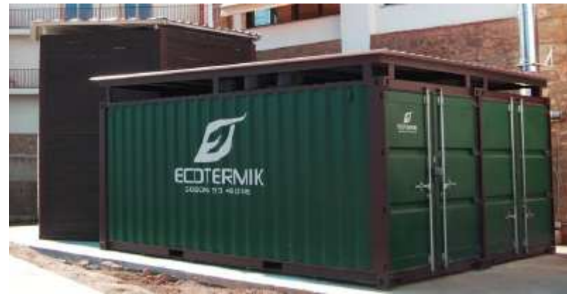
Silo en superficie
