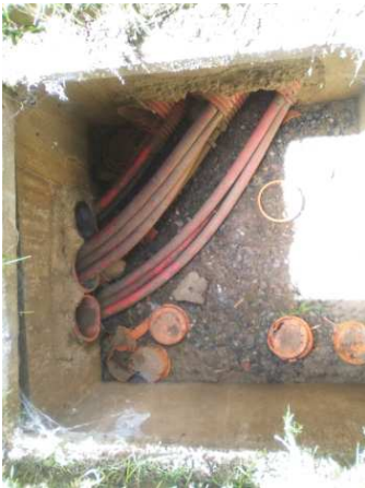
Foto 9.- Fotografía de los tres conjuntos de cables eléctricos.
