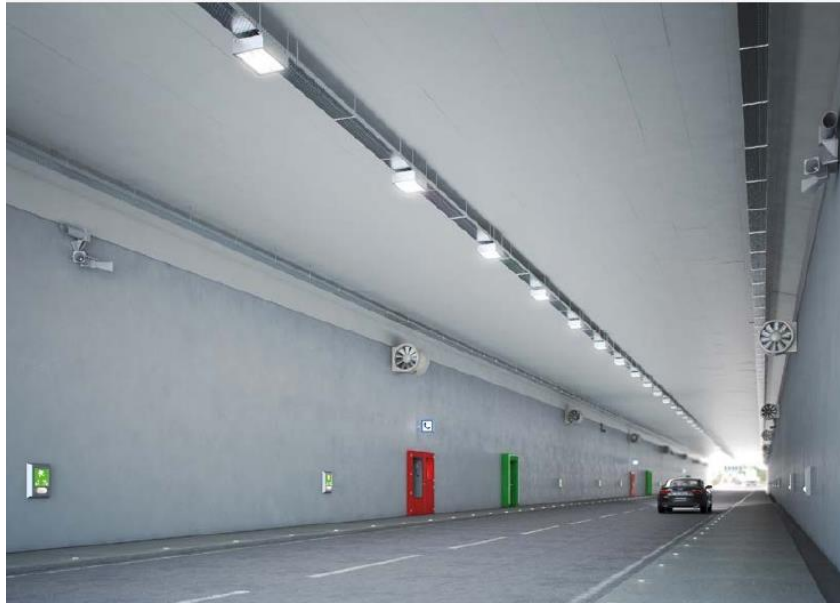
Figura 10: Protección contra incendios
