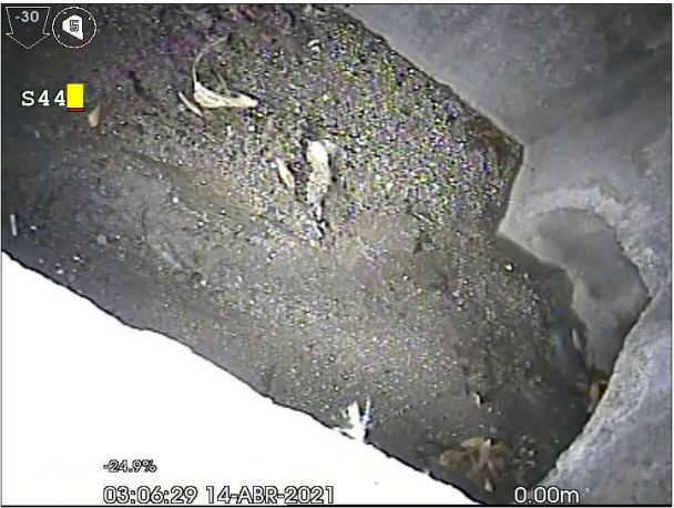
Fotografía: 145b, N° Video: 52, 00:00:00 0m, Fin de la inspección
