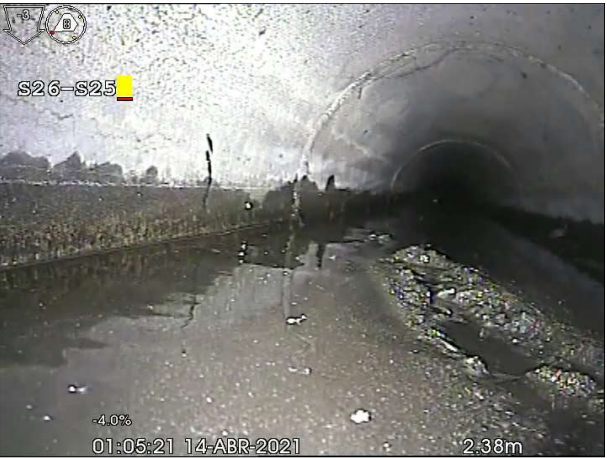
Fotografía: 92b, N° Video: 31, 00:00:26 2,4m, Inspección interrumpida, La cámara no puede avanzar.
