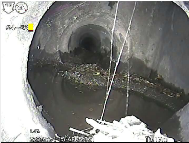
Fotografía: 23b, Nº Video: 5, 00:02:46 18,2m, Fin de la inspección, Arqueta S3
