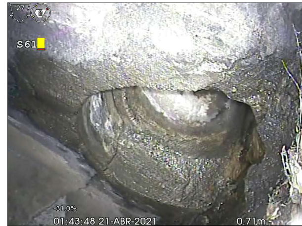
Fotografía: 205b, N° Video: 73, 00:00:00 0,2m, Fin de la inspección
