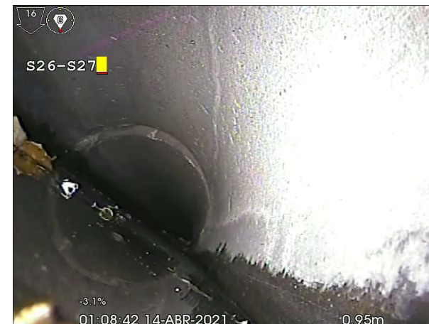
Fotografía: 95a, N° Video: 32, 00:00:19 1m, Inspección interrumpida, La cámara no puede avanzar.
