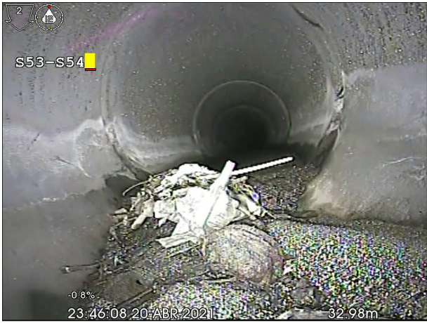
Fotografía: 166a, N° Video: 60, 00:04:58 33,7m, Inspección interrumpida, La cámara no puede avanzar.
