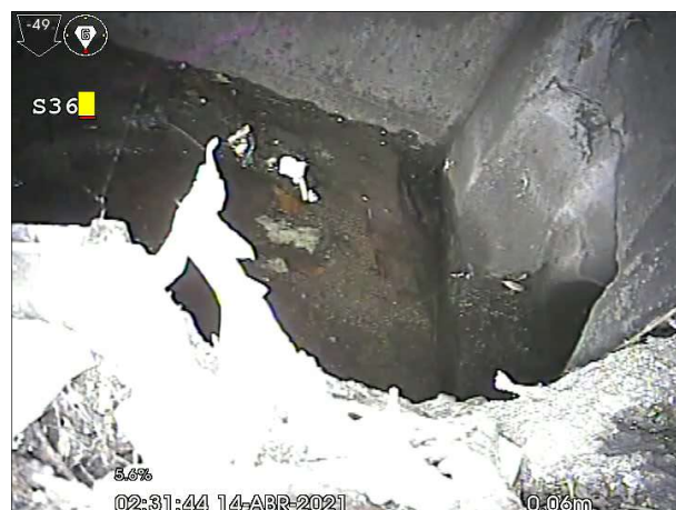
Fotografía: 129b, N° Video: 44, 00:00:00 0m, Fin de la inspección
