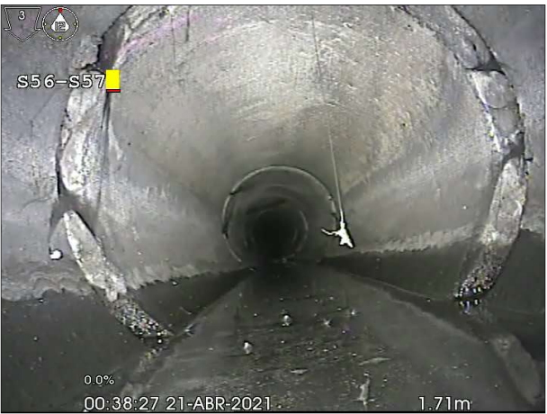
Fotografía: 188a, N° Video: 67, 00:00:31 1,7m, Inspección interrumpida, La cámara no puede avanzar.
