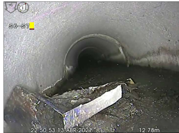
Fotografía: 34a, Nº Video: 9, 00:01:39 13,7m, Inspección interrumpida, Obstaculo de sedimentaciones.
