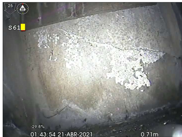
Fotografía: 208a, N° Video: 73, 00:00:00 0m, Grieta en la pared.
