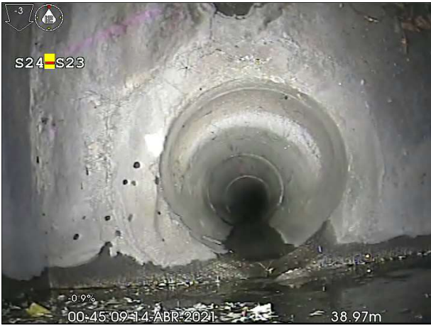
Fotografía: 83b, Nº Video: 28, 00:04:52 38,9m, Fin de la inspección, Arqueta S23
