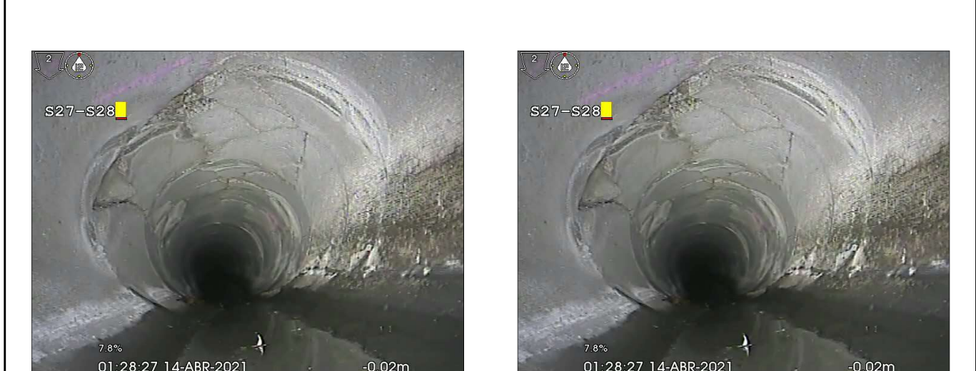
Fotografía: 99a, N° Video: 34, 00:00:00 0m, Inicio de la inspección, Arqueta S27 Fotografía: 100a, N° Video: 34, 00:00:00 0,2m, Roturas. Faltan trozos desde 12 hasta 12 horas, en 2
