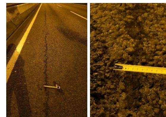
Figura 1 - PK 11+500 a 11+760 (Bilbao-Getxo): Grieta Longitudinal
