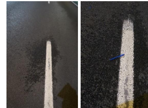
Figura 5 - PK 12+570 (Getxo-Bilbao): Desprendimiento
