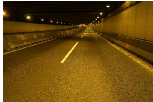
Figura 3 - PK 11+880 (Bilbao-Getxo): Aspecto General del Firme
