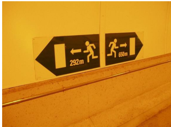
“Señalización de salidas dentro del túnel”.
