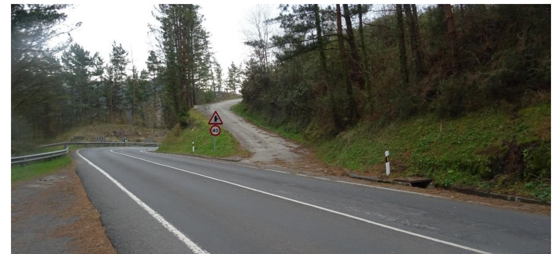
P.K. 57+100. Curva con radio de 50 m - Acceso a sidrería. Punto de concentración de accidentes.
