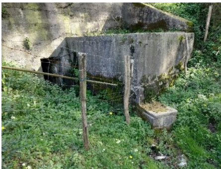
Depósito adosado al muro de la carretera
