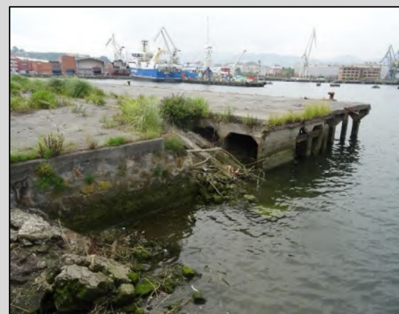
Hundimiento puntual. Vista hacia Bilbao
