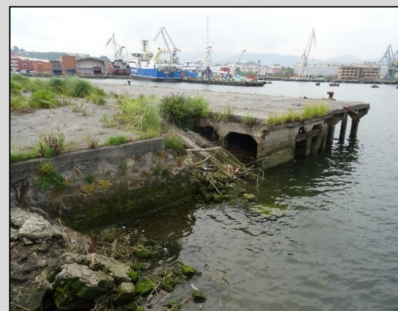
Hundimiento puntual. Vista hacia Bilbao
