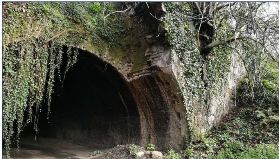
Imagen 11: Boquilla lado Basauri, donde se aprecian los desprendimientos propiciados por la presencia de varias higueras que crecen en su paramento
