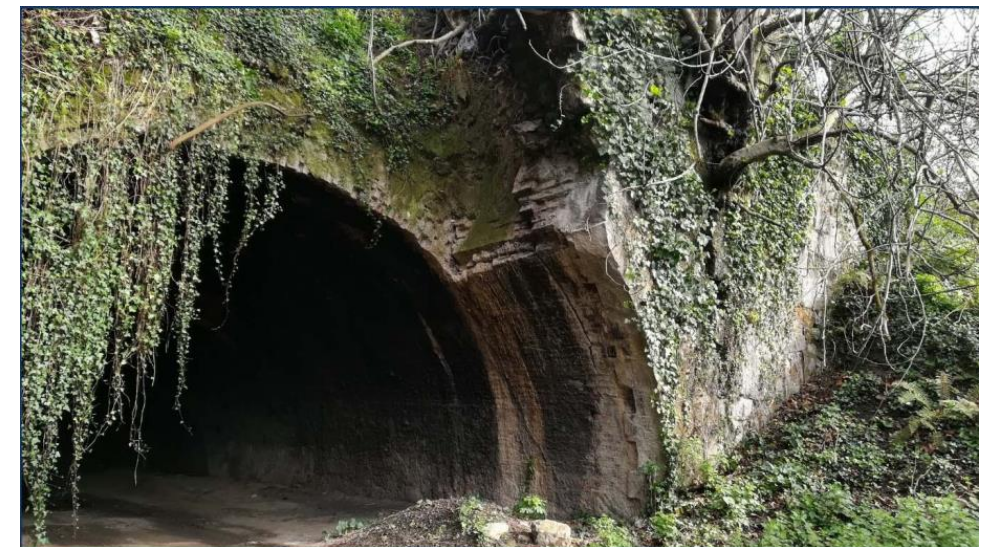
Imagen 10: Boquilla lado Basauri, donde se aprecian los desprendimientos propiciados por la presencia de varias higueras que crecen en su paramento
