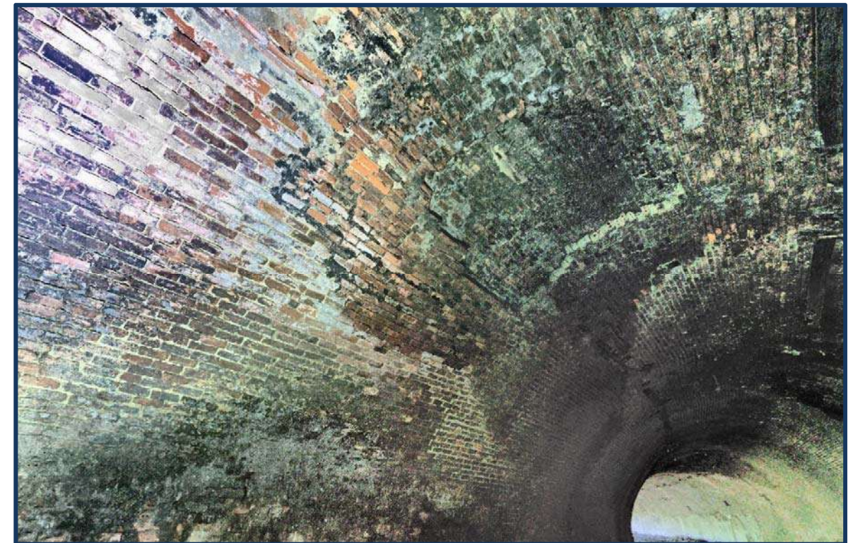
Aspecto del revestimiento en los alrededores del p.k. 0+087. Vemos el desconchón y la pérdida de la primera capa de ladrillos del revestimiento junto a una reparación y colocación de nuevos ladrillos.
