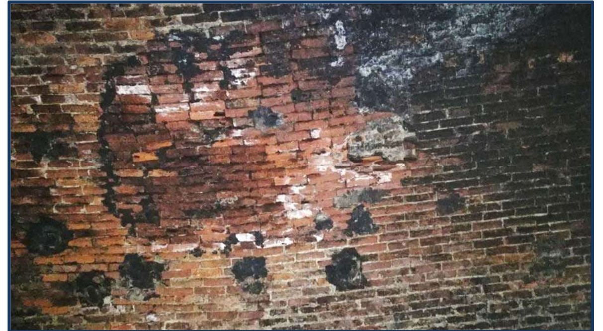
Antigua incidencia donde se aprecia la pérdida del revestimiento de ladrillo y la reparación de la misma con una nueva capa de ladrillos colocados de forma poco cuidadosa.
