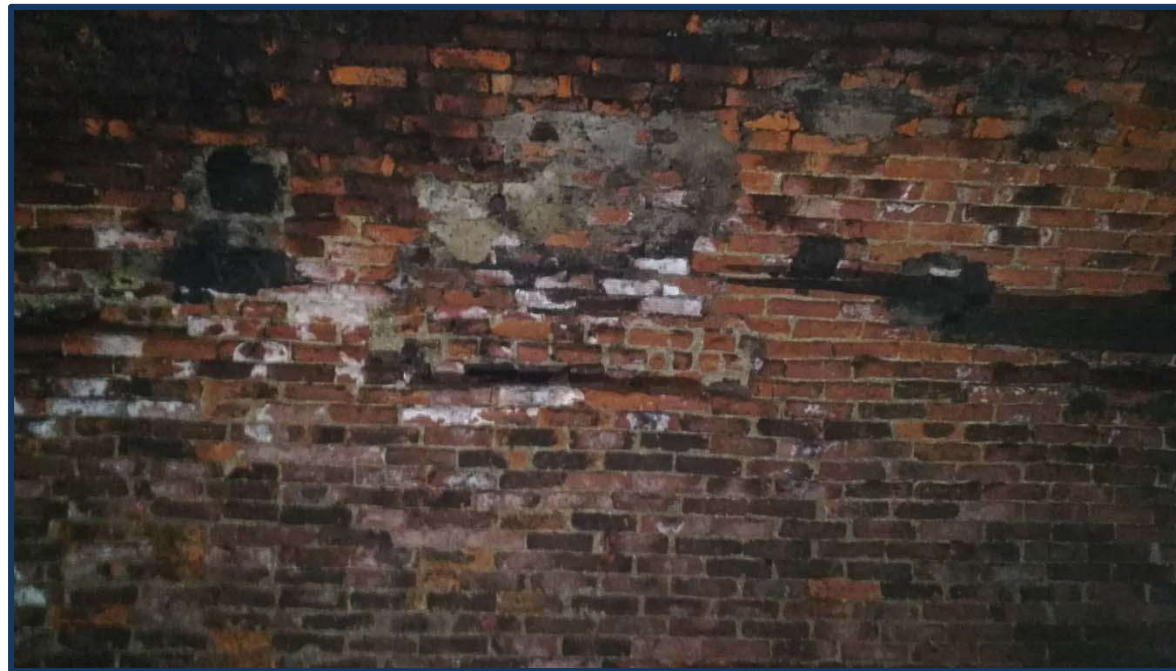
Desconchón junto a una antigua reparación efectuada con un parche de cemento.
