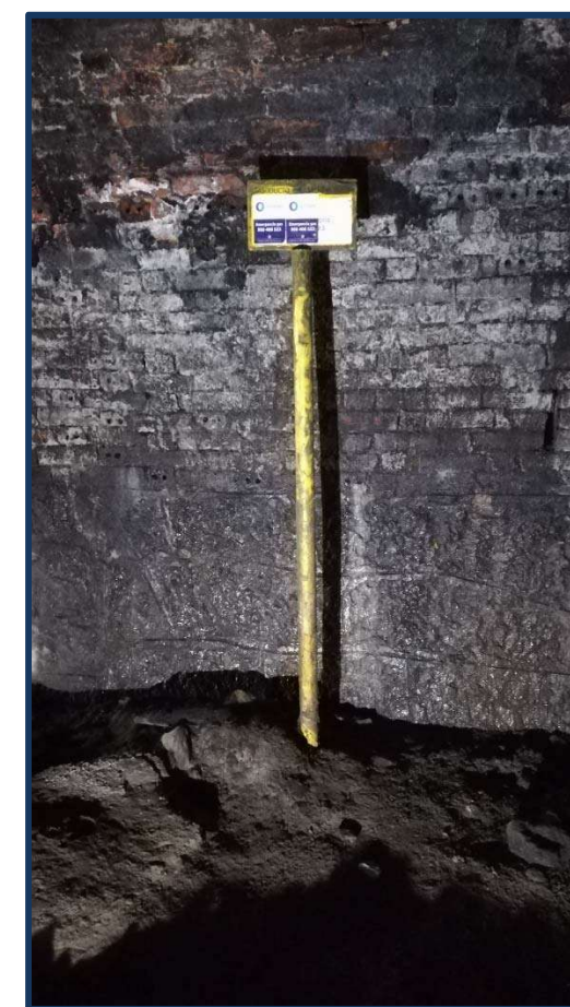
Hito informativo del gasoducto.
