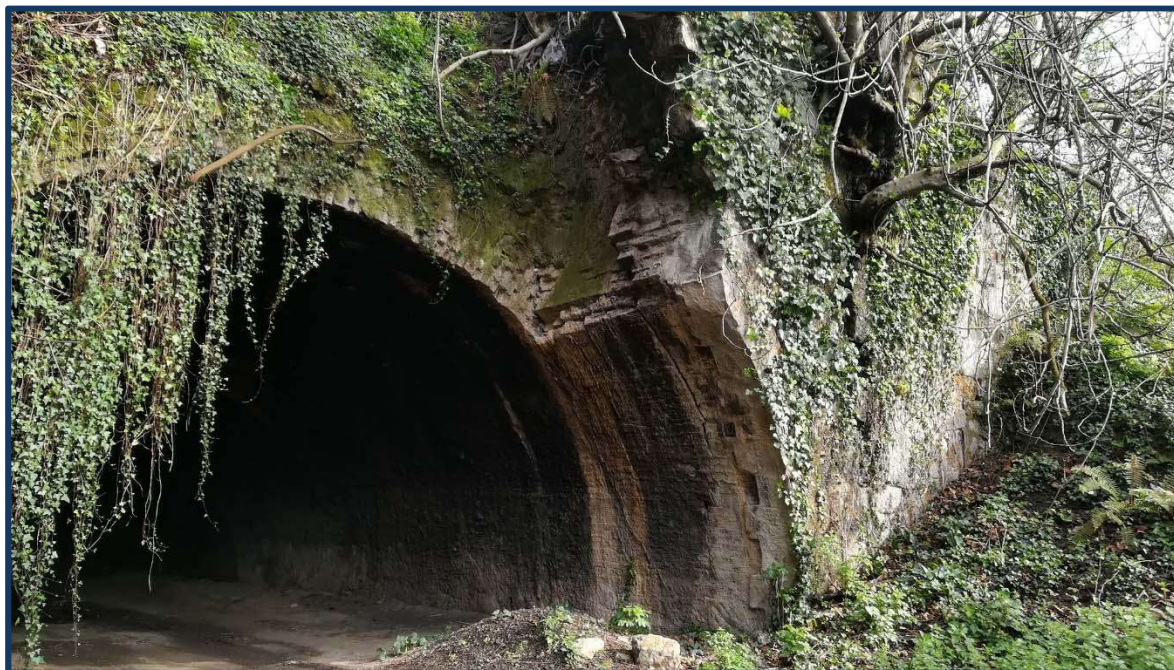
Boquilla lado Basauri, donde ha caído parte de los tres primeros metros propiciados por la presencia de varias higueras que crecen en su paramento.
