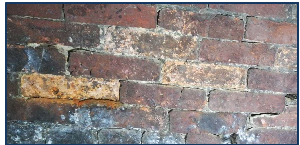
Desconchones originados por presencia de precipitados en los poros que afecta de forma desigual a cada uno de los ladrillos.
