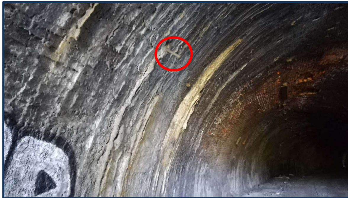
Tubo de drenaje recogido con un parche de cuero presente en los primeros metros del túnel en su parte Boqueta.
