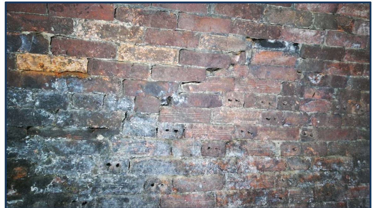
Pequeña grieta que parece haber sido reparada. Se observa la zona repuesta ya que se realizó con ladrillos que presentan unas estrías en su lado que se diferencia con los ladrillos lisos originales.
