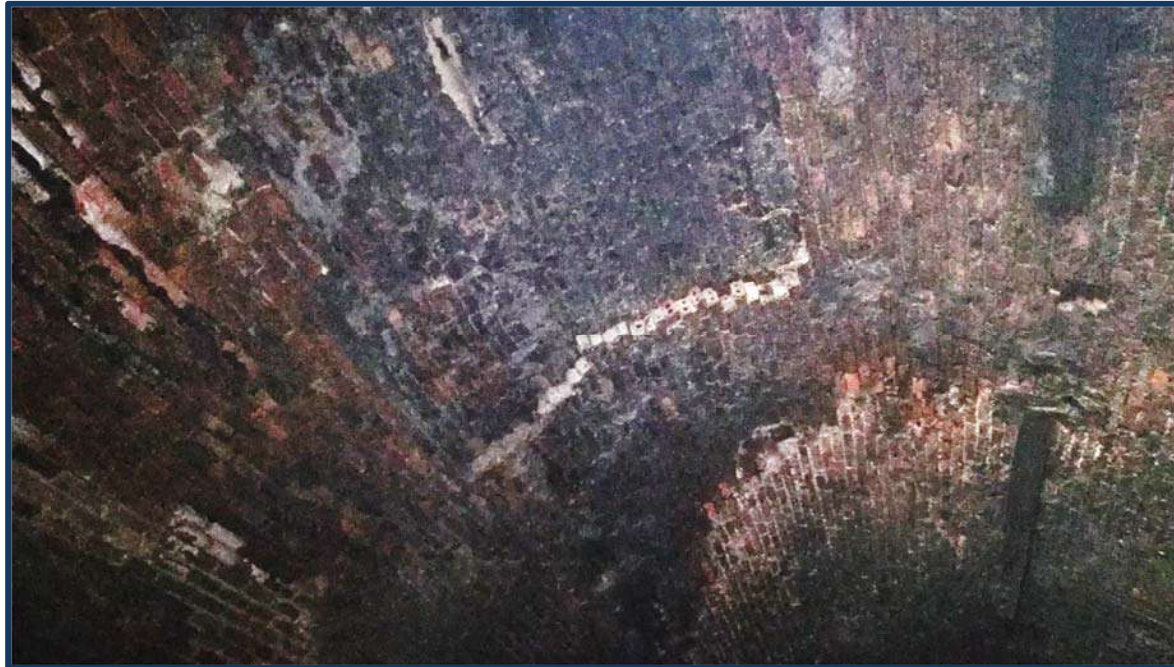
Zona con pérdida de la capa exterior del revestimiento de ladrillos.
