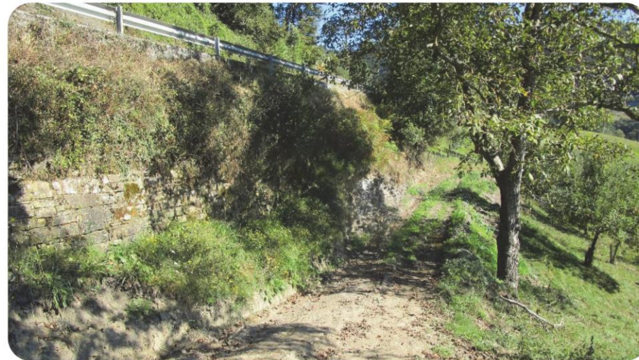
50+750 Muro de mamposeria sobre coluvial inestable
