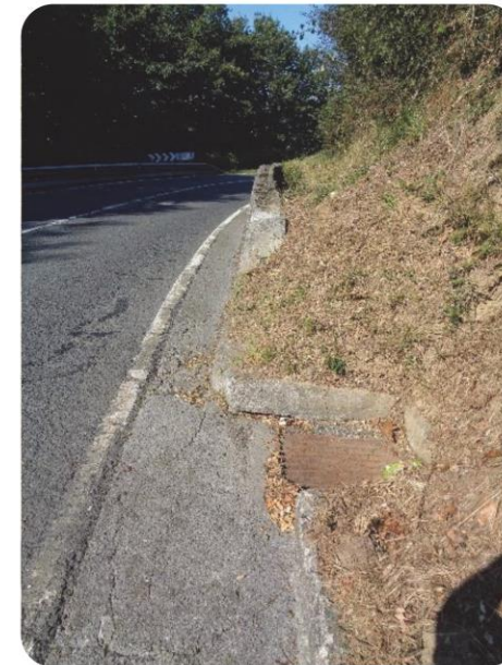
49+750 Muro en MD -1
