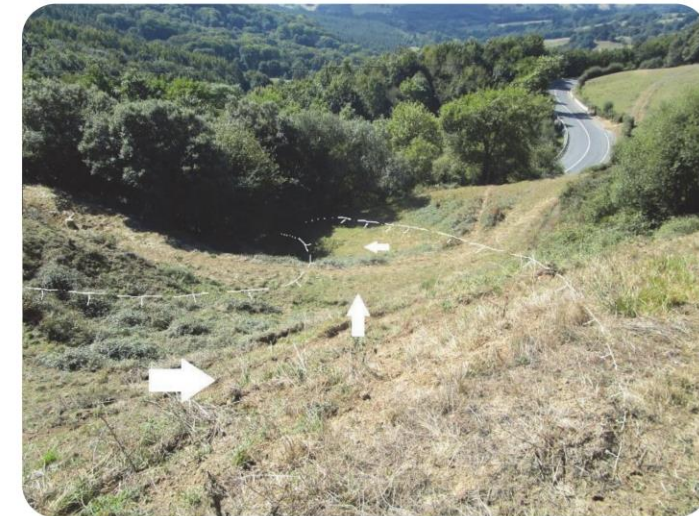
49+400 Antiguo Deslizamineto-Area de erosión
