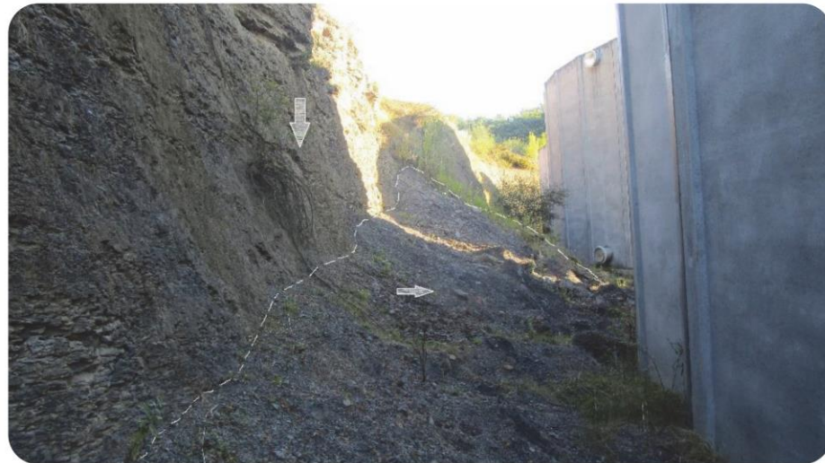
51+900 Planta Purines, chineo por degradación de la roca expuesta
