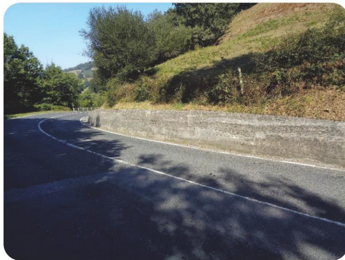
49+750 Muro en MD
