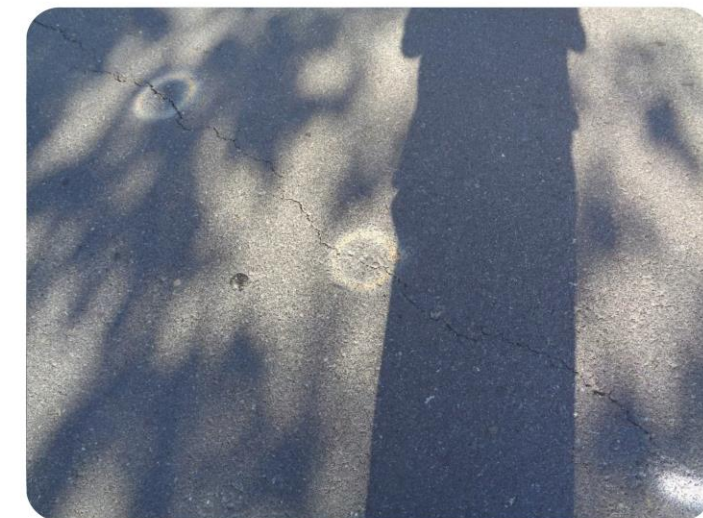
50+720 Detalle fisuración pavimento
