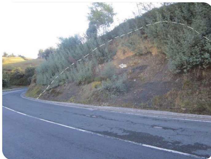
49+300 Deslizamiento roca alterada con MTT
