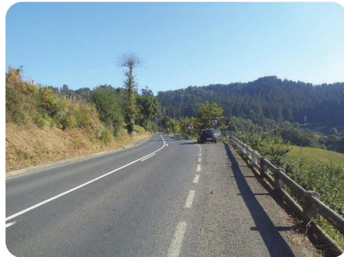
50+680 sobrealcho en MI muro en MI
