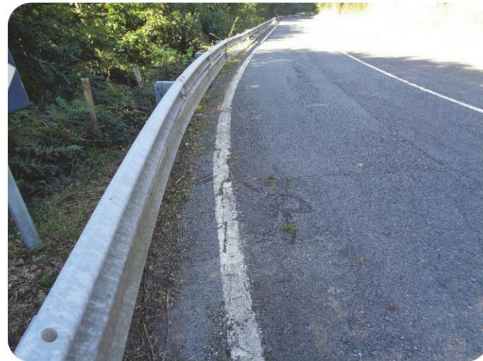
49+700 Muro en zona recta anclado y con patologías
