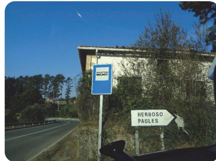
52+500 Subida a Paules casa con grietas
