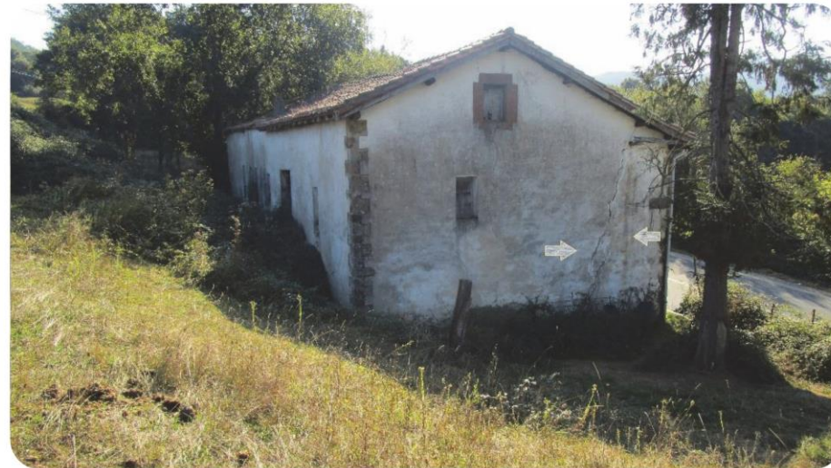
52+360 Gran zona coluvial casa agrietada
