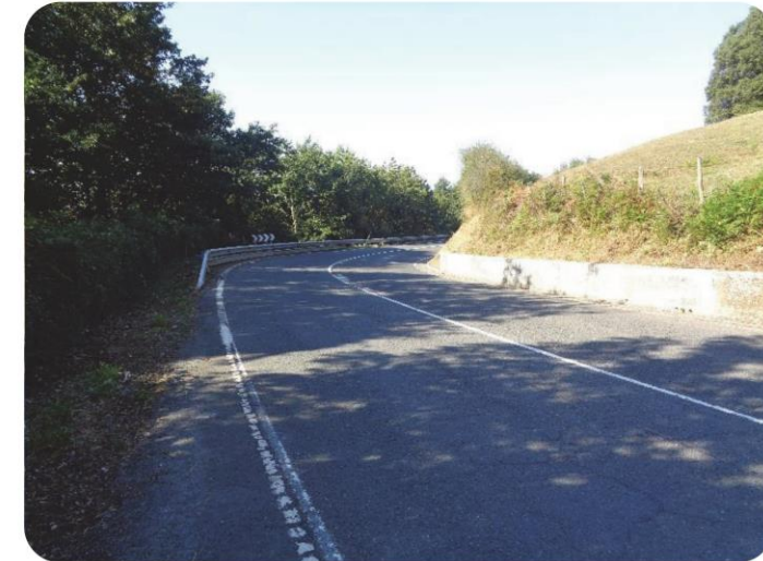
49+620 muro en MD
