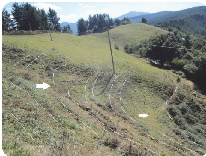
49+500 Reptaciones sup por fuertes pendientes
