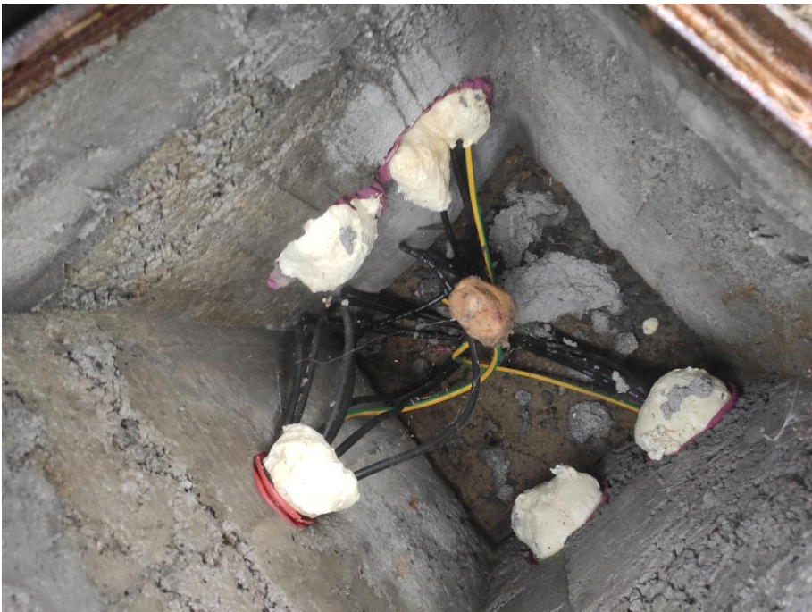
FIGURA 4. ARQUETAS ALUMBRADO PASARELA. SECTOR ESTE
