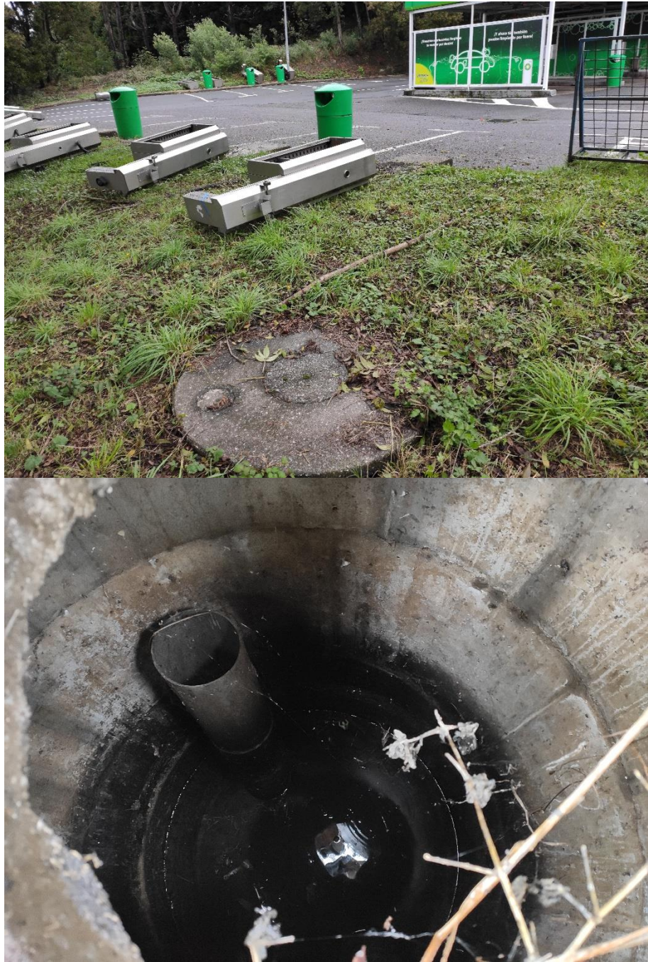
FIGURA 24. FOSO DECANTADOR ZONA LAVADO
