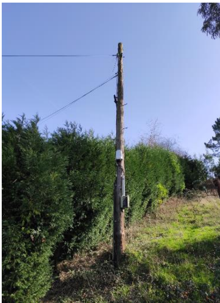
FIGURA 8. POSTE A REPONER. TRANSICIÓN LÍNEA SUBTERRÁNEA - AÉREA
