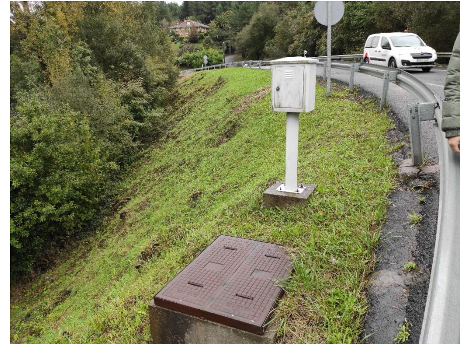
FIGURA 12. ARMARIO DETECTOR Y ARQUETA A REPONER
