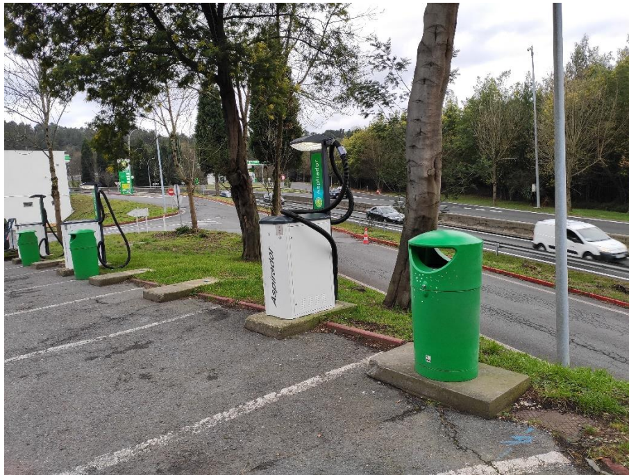
FIGURA 21. ARQUETA DE ALUMBRADO Y ELECTRICIDAD, ZONA DE ASPIRADORES, A REPONER
