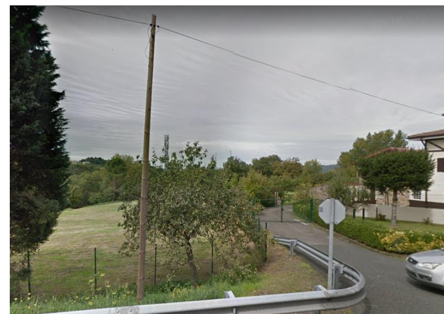
FIGURA 9. POSTE DE CONEXIÓN. TRANSICIÓN LÍNEA SUBTERRÁNEA - AÉREA EN REPOSICIÓN
