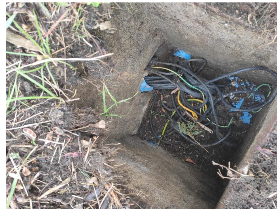
FIGURA 20. ARQUETA DE ALUMBRADO Y ELECTRICIDAD FINAL VÍA DE SERVICIO
