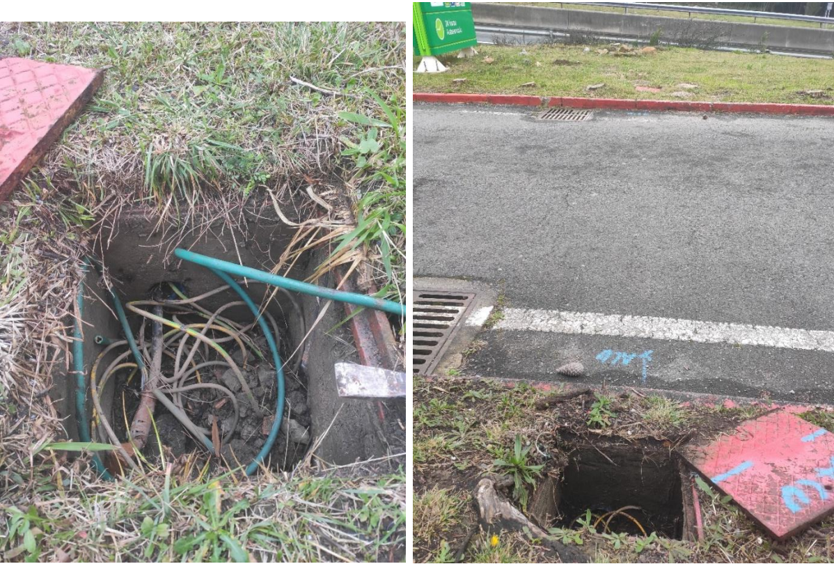
FIGURA 18. ARQUETAS ALUMBRADO GASOLINERA Y CRUCE DE CALZADA
