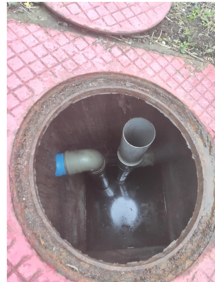
FIGURA 22. SEPARADOR HIDROCARBUROS PISTA GASOLINERA
