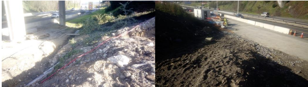
Estado de la parte baja del talud tras la limpieza y preparación de la superficie (24/02/2021)
